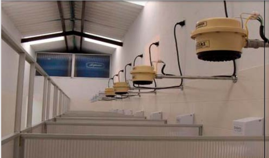
Figura 6. Duchas para personal que ingresa a la granja (trabajadores o visitantes) ubicadas en la zona intermedia
