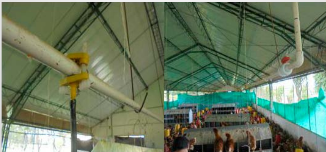
Figura 36. Sistema de acople de un bebedero a la red hidráulica que se encuentra a lo largo de la caseta
