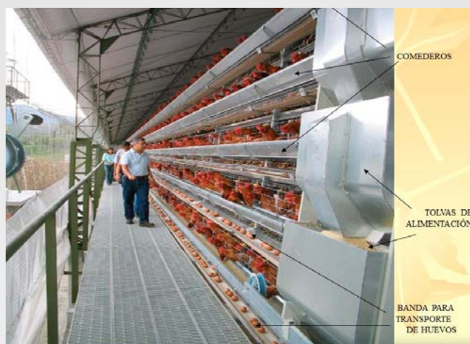
Figura 14. Detalles de automatización de jaulas para ponedoras comerciales
