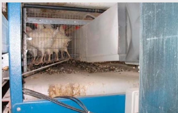
Figura 15. Banda transportadora de excretas
