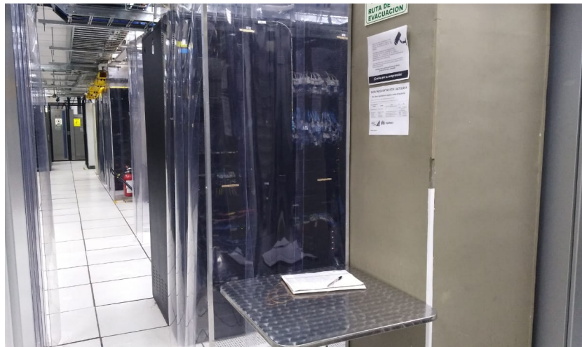
Figura 16. Cuarto de Equipos. Fuente propia
