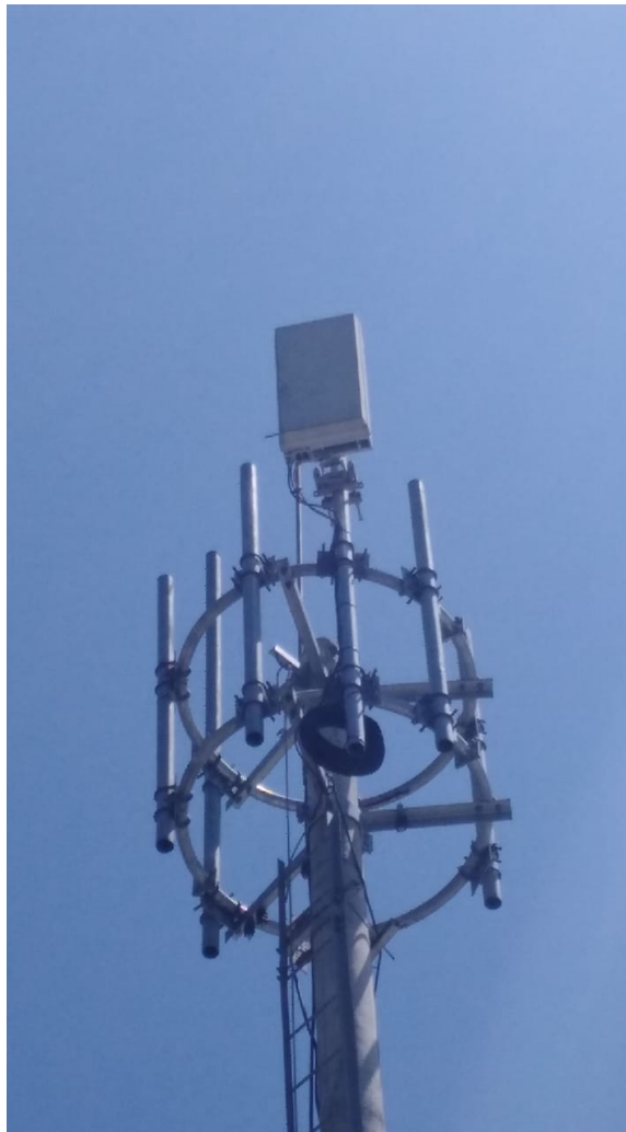
Figura 20. Instalación AAU en el poste
