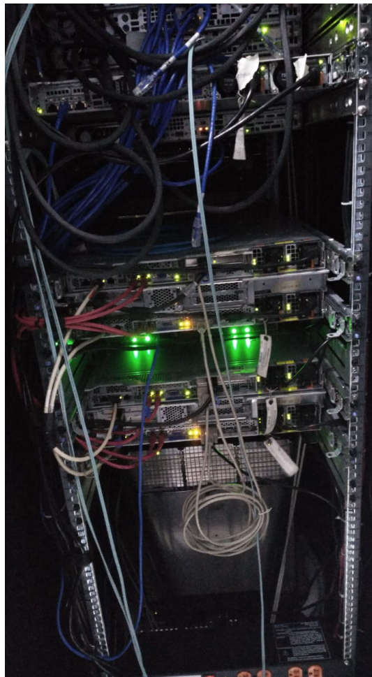
Figura 17. Rack. Fuente Propia
