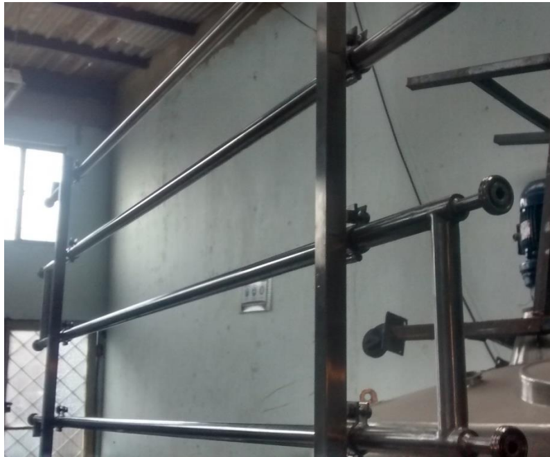
Figura 54 Horquillas del intercambiador de tubos concéntricos. Fuente: Autor
