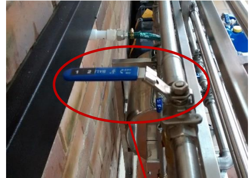
Abrir la válvula N°12 para permitir la salida del agua
