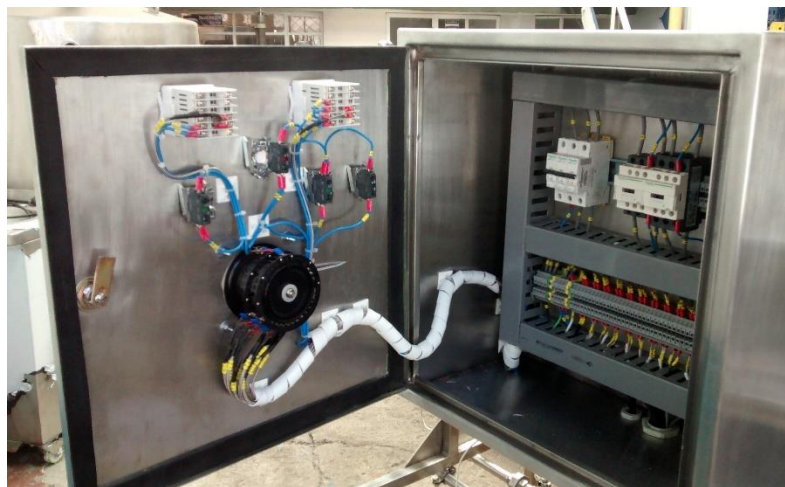
Figura 60 Cableado interno del tablero de control. Fuente: Autor
