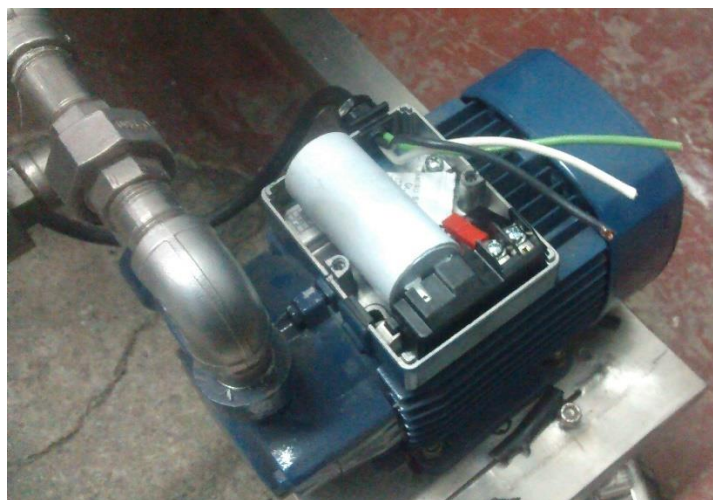
Figura 58 Cableado de control y potencia de la bomba en el banco de pruebas. Fuente: Autor.
