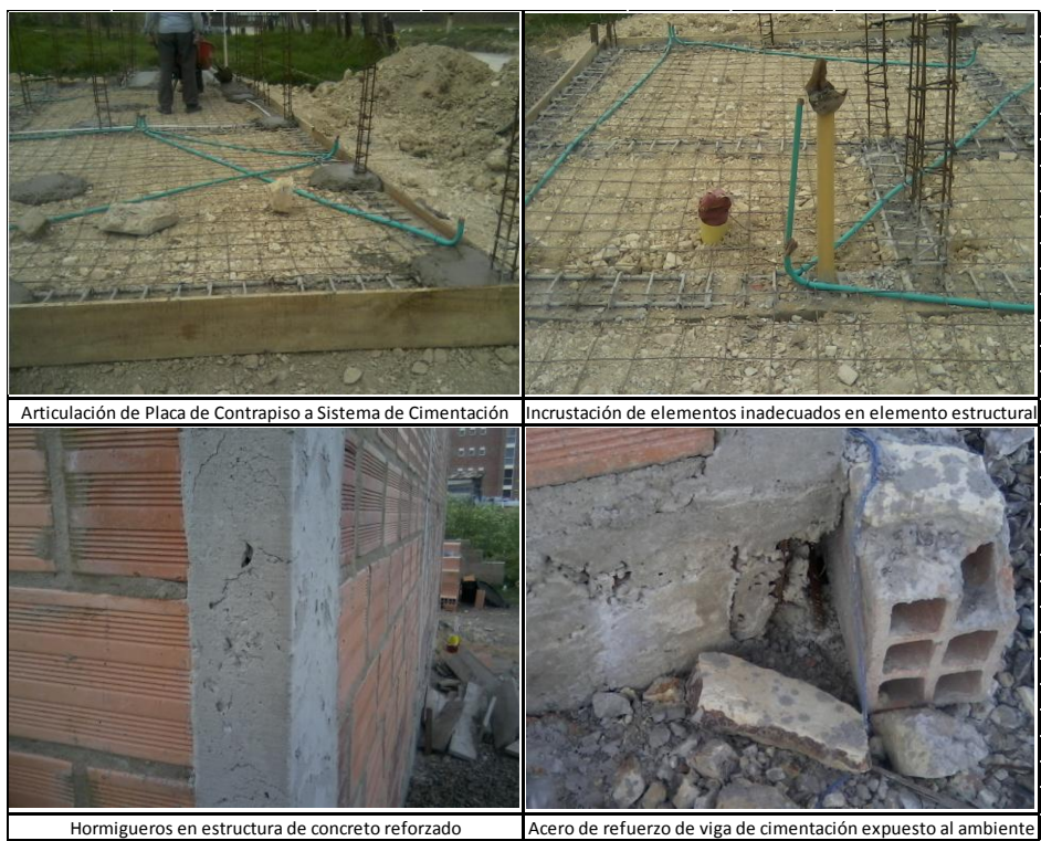
Imagen 16. Falencias detectadas en obra de construcción de vivienda
