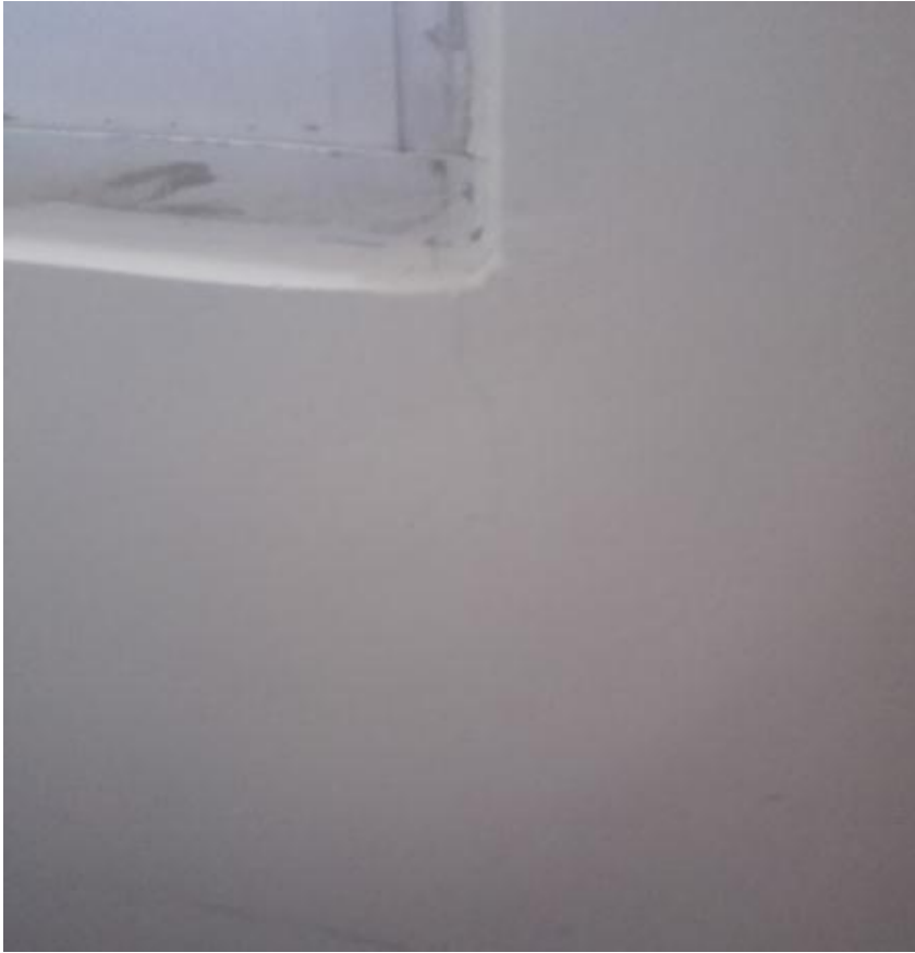
Imagen 26. Fisuras en vanos de apartamento 502 Torre 2 Conjunto Reservas de Alameda
