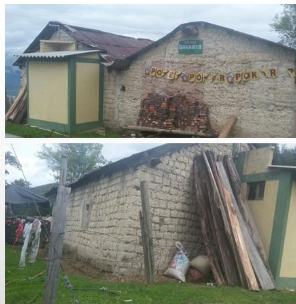
Imagen 7. Deficiencia en Cubierta Zona Rural Vereda San Antonio Norte
