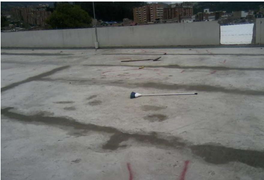
Imagen 22. Identificación y reparación de fisuras de placa de parqueadero Urbanización Avatar
