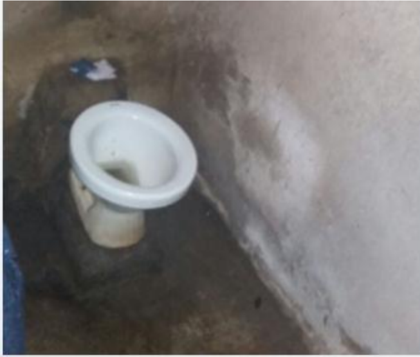
Imagen 9. Vivienda rural con deficiencia en aparatos sanitarios.
