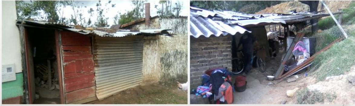
Imagen 8. Prácticas Inadecuadas en Sistemas de Cubierta
