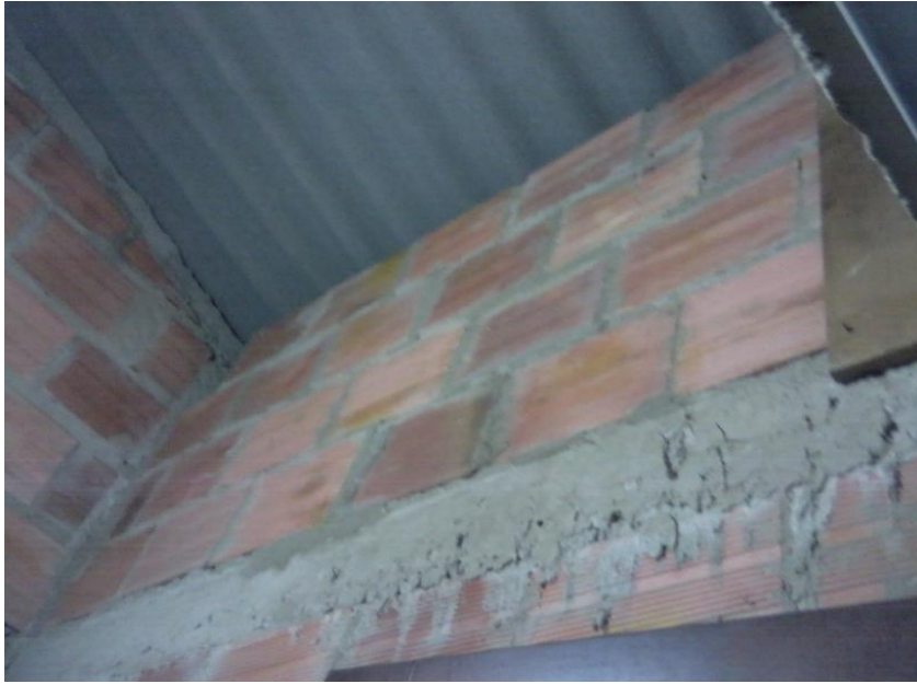
Imagen 19. Muro de terminación de culata sin sistema de confinamiento.
