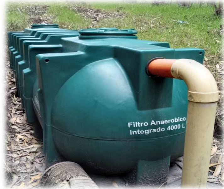
Figura 23. Filtro Anaerobio Mina San Miguel.
