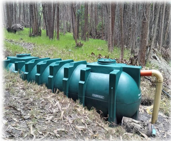
Figura 24. Fil Filtro anaerobio Mina San Miguel.
