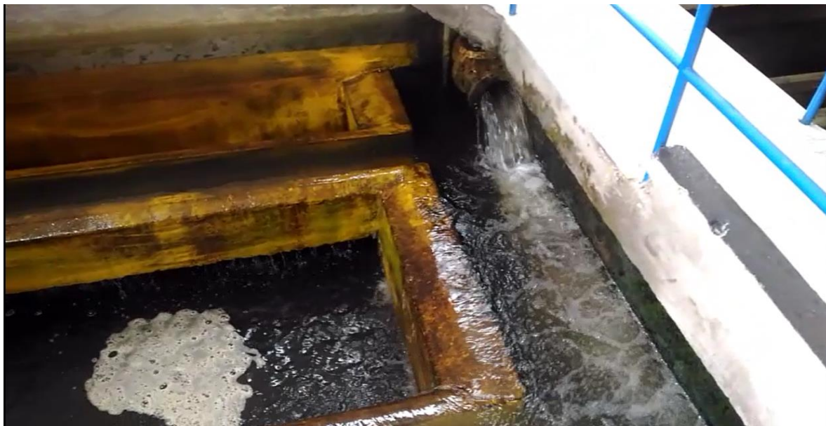
Imagen 17. Filtro en funcionamiento
