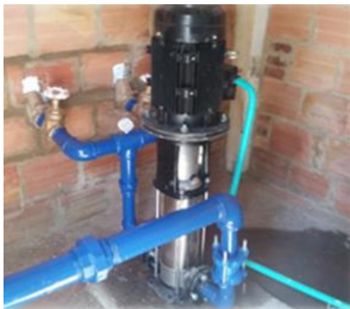
Imagen 32. Bomba de segunda estación
