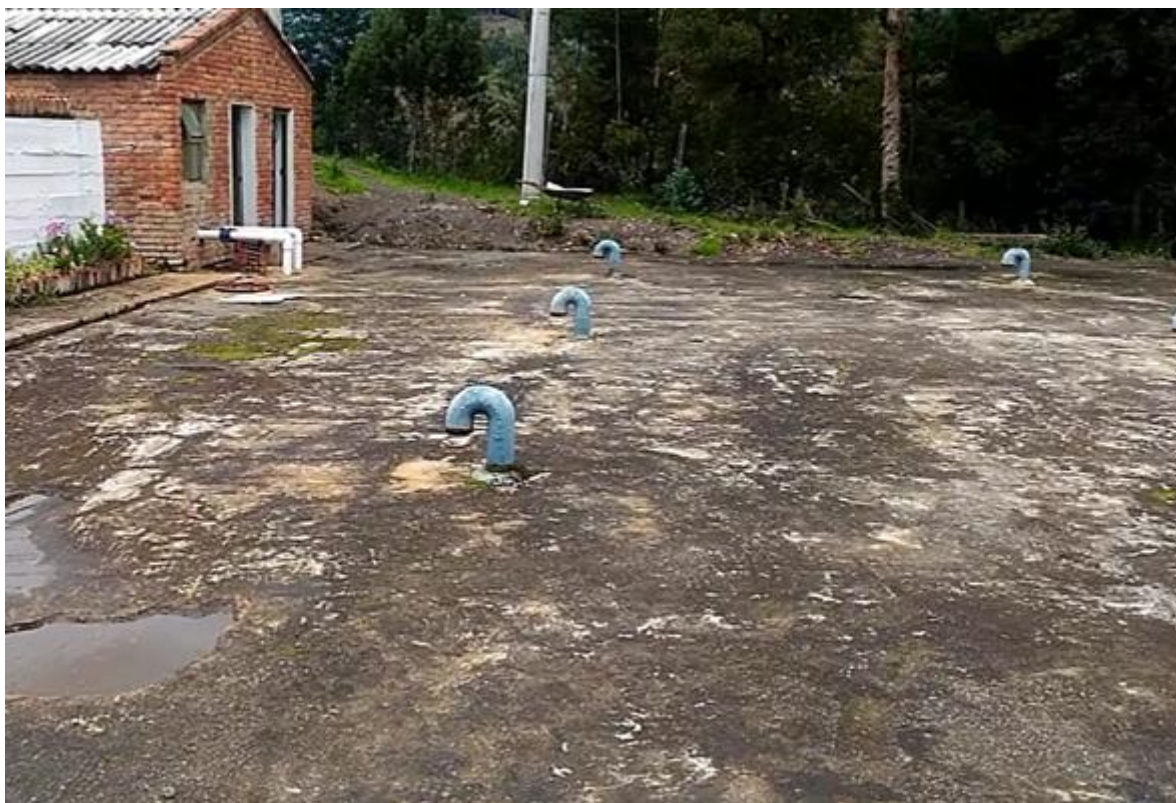
Imagen 24. Tanque de distribución No.1
