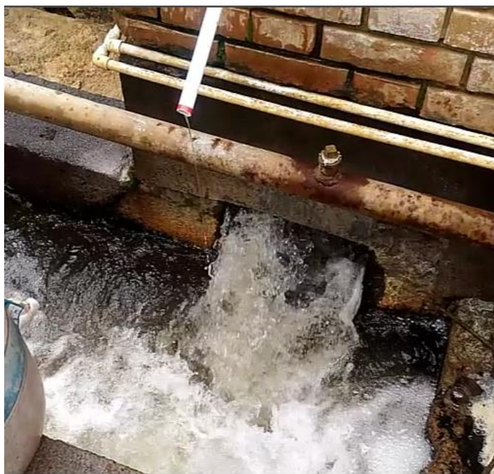
Imagen 8. Paso de canaleta Parshall a canal
