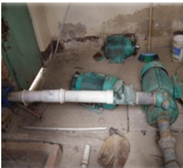
Imagen 33. Bomba de tercera estación
