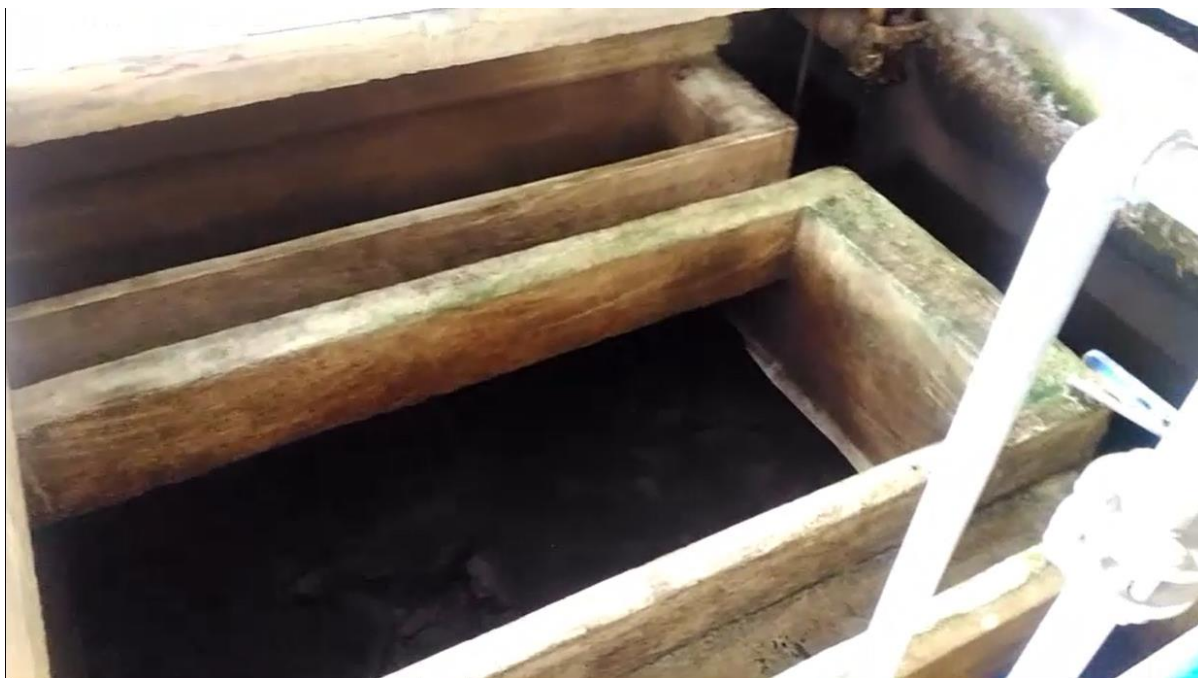
Imagen 18. Filtro en mantenimiento
