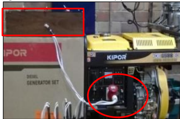
Figura 8. Tablero de control y planta eléctrica.
