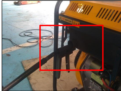
Figura 15. Sonda y exosto de planta eléctrica.
