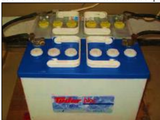
Ilustración 4. Baterías de almacenamiento conectadas en paralelo.
