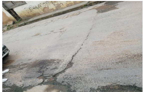
Fotografía 48. resalto circular pésima condición
