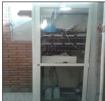
Imagen 9 Maquina en desuso
