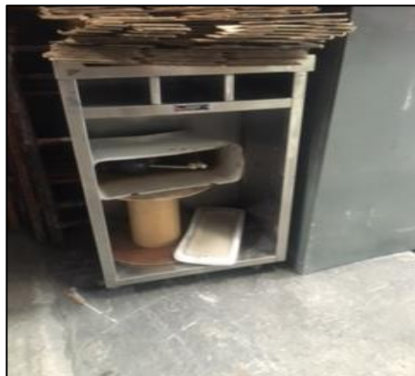
Imagen 8 Sanitario en desuso
