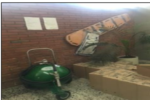
Imagen 15 Extintor no señalizado
