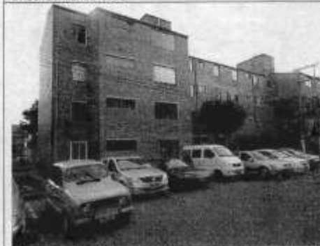
Fotografía 9. Vista de fachada norte del bloque 10, evidencia daños leves.
