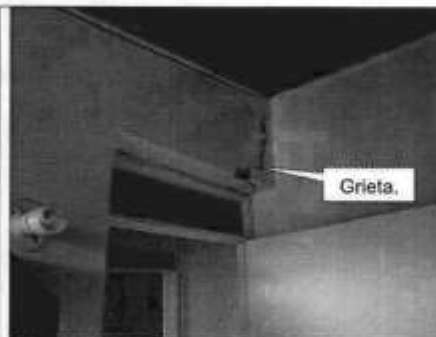
Fotografía 4. Vista de muro interno del apartamento 402 bloque 8 interior 3, se observa la presencia de grietas.
