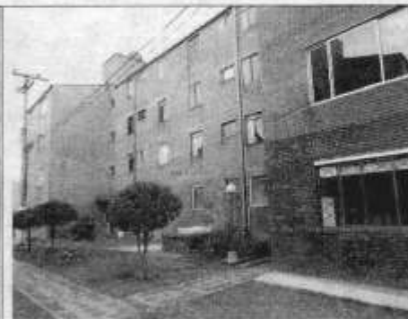
Fotografía 20. Vista de fachada norte del bloque 8, evidencia daños fuertes.
