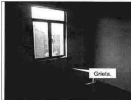
Fotografía 3. Vista de muro de fachada del apartamento 402 bloque 8 interior 3, se observa la presencia de grietas.
