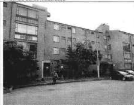
Fotografía 16. Vista de fachada norte del bloque 5, evidencia daños moderados.
