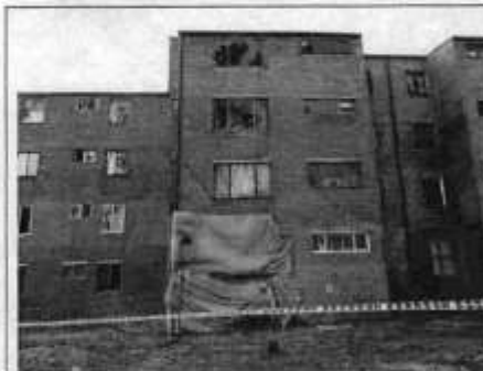
Fotografía 1. Vista de fachada sur del bloque 8, evidencia daños fuertes, se evidencian fisuras y grietas sobre muros (imagen tomada el 29 de Septiembre de 2016).
