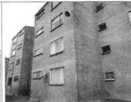
Fotografía 4. Vista de fachada occidental del bloque 3, evidencia daños leves.
