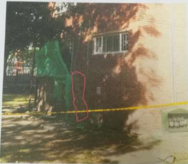
Fotografía No. 1. Vista agrietamiento de muro
