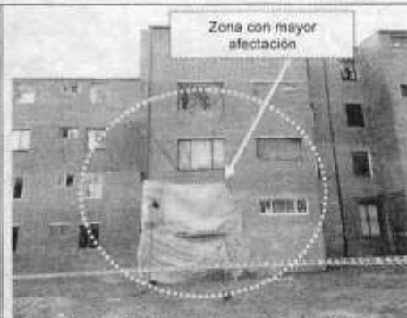
Fotografía 18. Vista de fachada sur del bloque 8, evidencia daños fuertes, se evidencian fisuras y grietas sobre muros.
