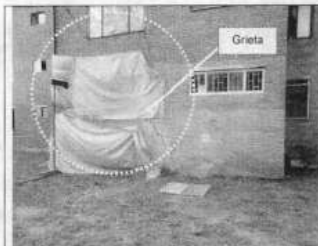
Fotografía 19. Vista en detalle de fachada norte del bloque 8, evidencia daños fuertes, se evidencian fisuras y grietas sobre muros.
