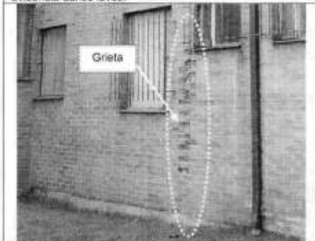
Fotografía 15. Vista en detalle de muro de primer nivel (costado sur) del bloque 2, daños moderados.
