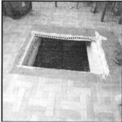
Fotografía 7. Fisuras de tendencia longitudinal en el espesor de las plaquetas prefabricadas alrededor de la plaqueta colapsada
