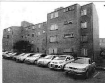
Fotografía 12. Vista de fachada occidental del bloque 13, evidencia daños leves.
