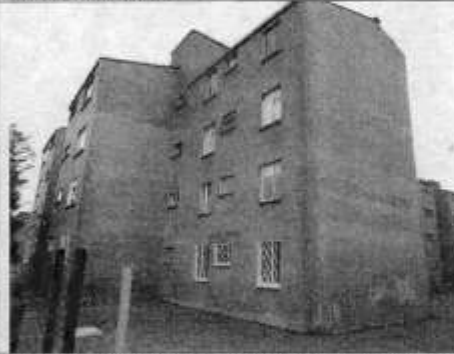
Fotografía 8. Vista de fachada sur del bloque 9, evidencia daños leves.
