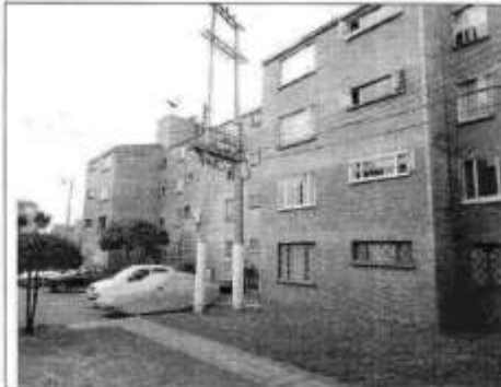
Fotografía 11. Vista de fachada sur del bloque 12, evidencia daños leves.
