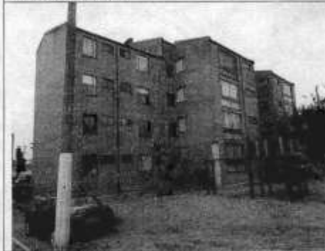
Fotografía 7. Vista de fachada norte del bloque 7, evidencia daños leves.
