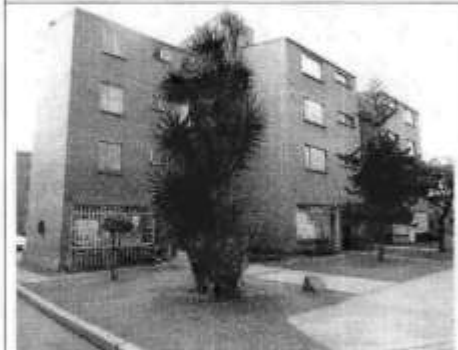
Fotografía 13. Vista de fachada oriental del bloque 16, evidencia daños leves.
