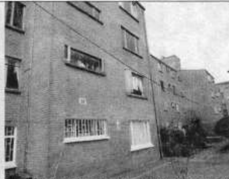
Fotografía 6. Vista de fachada oriental del bloque 6, evidencia daños leves.
