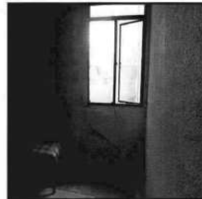
Fotografía 7. Fisuras en muros de fachada de las habitaciones del apartamento 202
