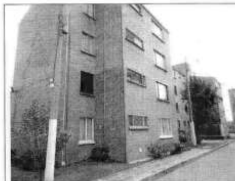
Fotografía 3. Vista de fachada norte del bloque 1, evidencia daños leves.
