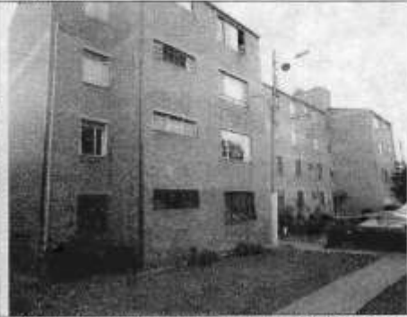
Fotografía 10. Vista de fachada sur del bloque 11, evidencia daños leves.
