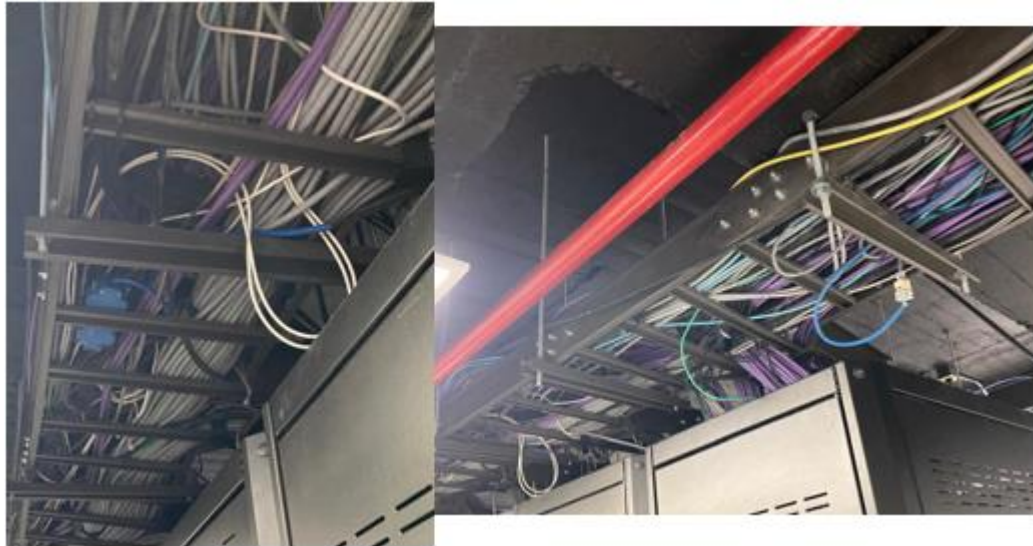
Figura 3: Análisis de las falencias en el cableado estructurado.
