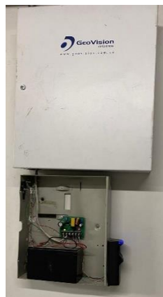
Figura 4: Vulnerabilidad del control del acceso al data center.
