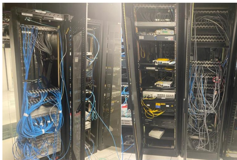
Figura 1: Estado actual en el que se encuentra en Data Center.
