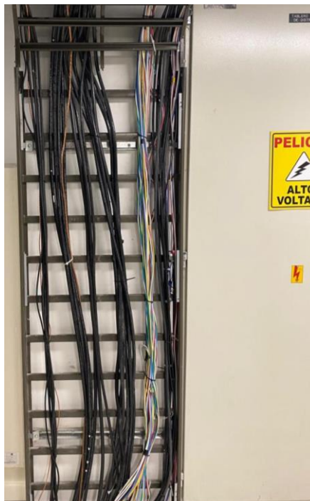
Figura 6: Punto de acceso eléctrico.
