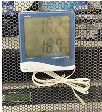
Figura 8: Medición de la temperatura del data center.
