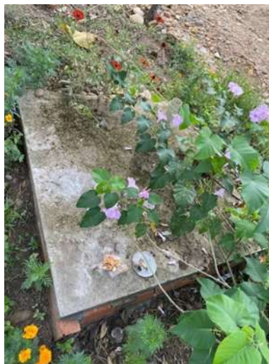
Figura 18 Pozo séptico con recubrimiento de ladrillo
