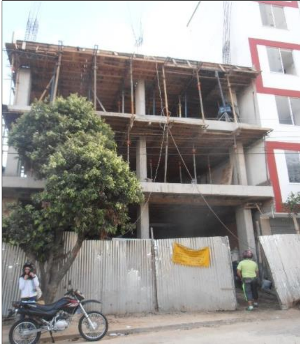
Figura 1. Fotografía de obra con caso de invasión de espacio público en el casco urbano de Bucaramanga.
