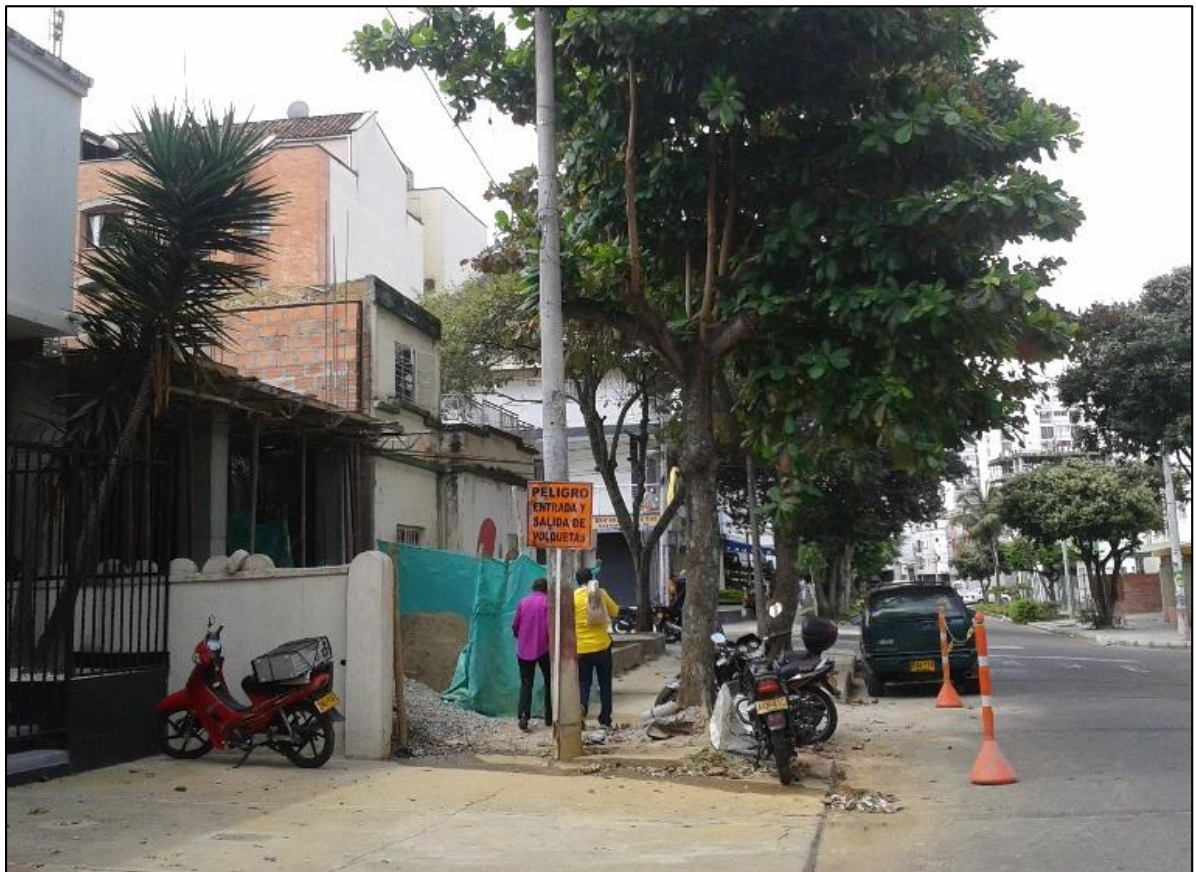
Figura 3. Fotografía de obra con caso de invasión de espacio público en el casco urbano de Bucaramanga.
