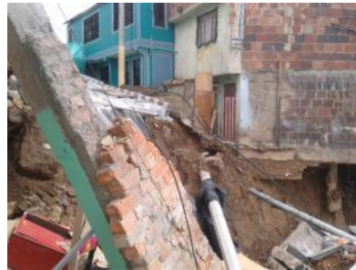
Varias viviendas se vieron afectadas. Fuente: Autoría propia.
