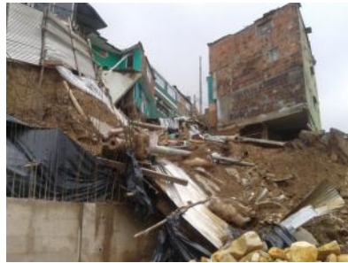
Zona del movimiento de remoción. Fuente: Autoría propia.
