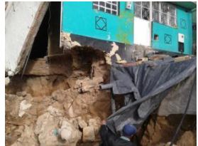
Arcillolita en el escarpe del movimiento de remoción y presencia de roca arenisca. Fuente: Elaboración propia.
