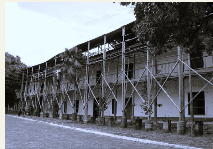
Antigua casa inglesa de Ambalema (2024) Muestra un detrimento en la estructura de su techo. Fotografía por El Cronista. Adaptado de ¿Cuál será el futuro de la Casa Inglesa en Ambalema, Tolima?
