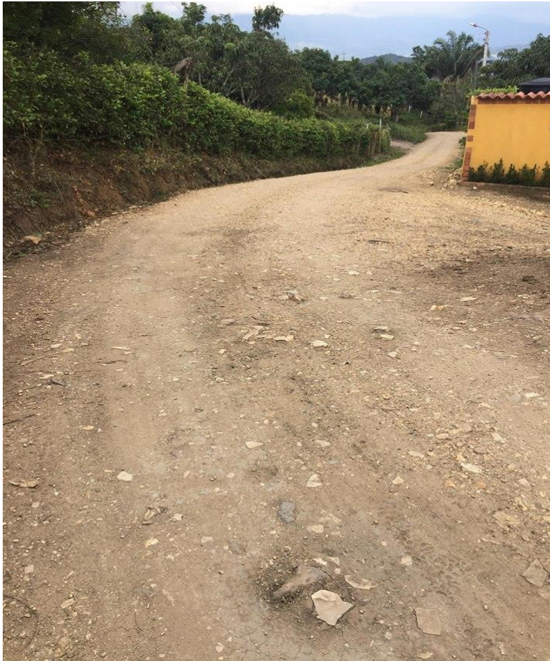
Fotografía 5. Estado actual de la vía
