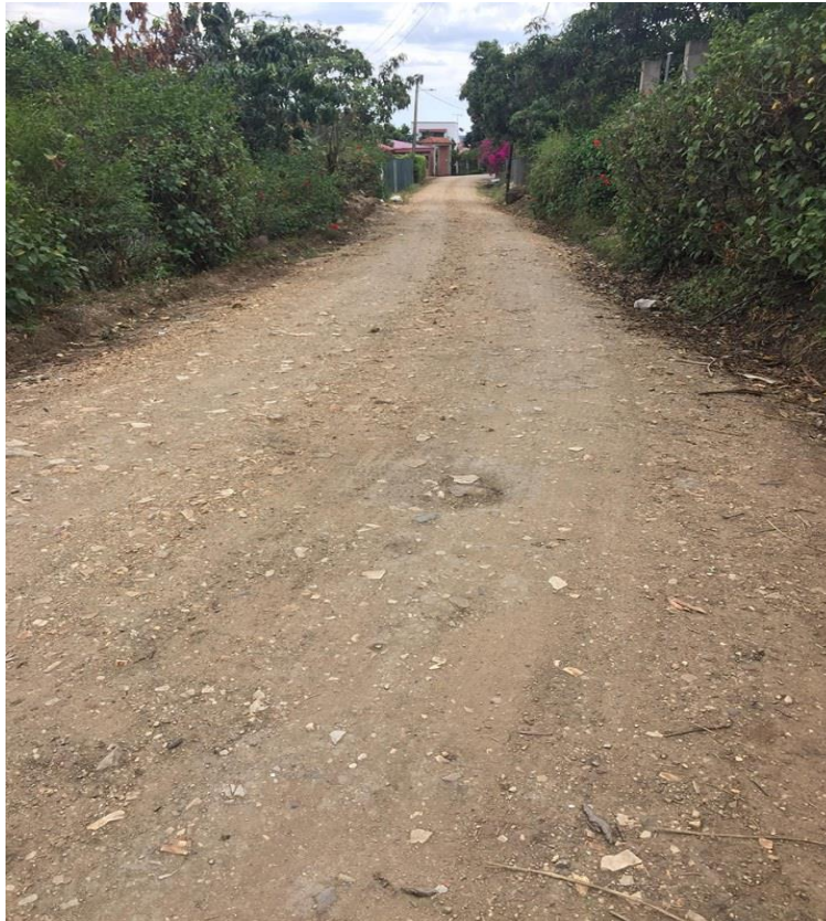
Fotografía 3. Estado actual de la vía
