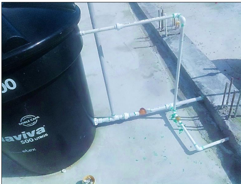
Figura 39. Tanque 500 litros instalado
