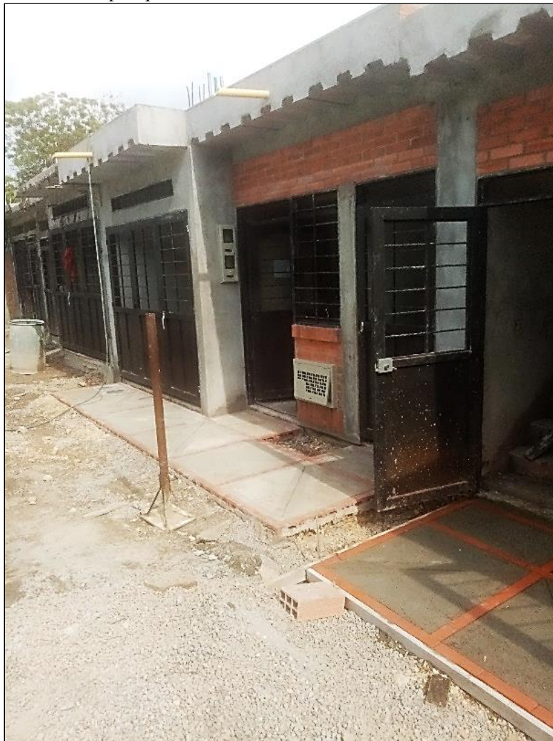
Figura 24. Tubería eléctrica por pared
