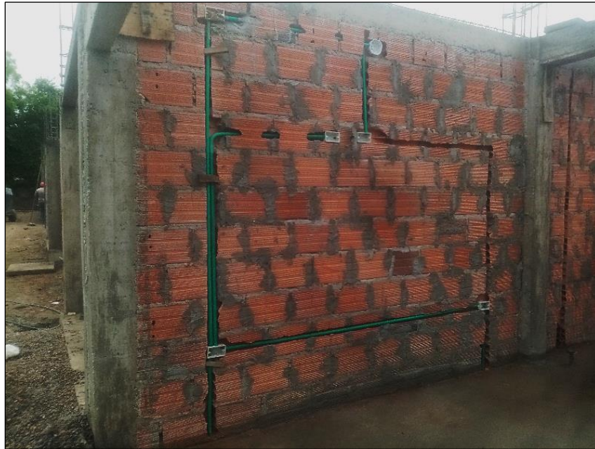
Figura 23. Tubería eléctrica por pared
