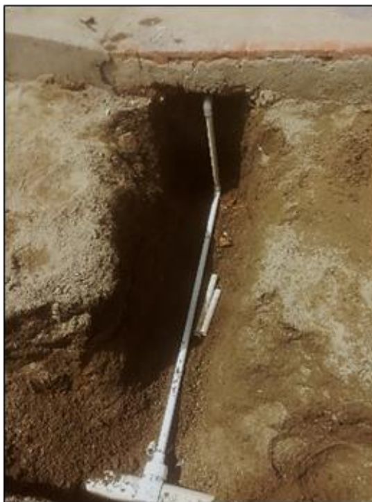
Figura 47. Acometida red de acueducto
