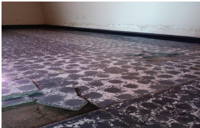
Ilustración 15 Lesión mecánica Fuente: Elaboración propia
