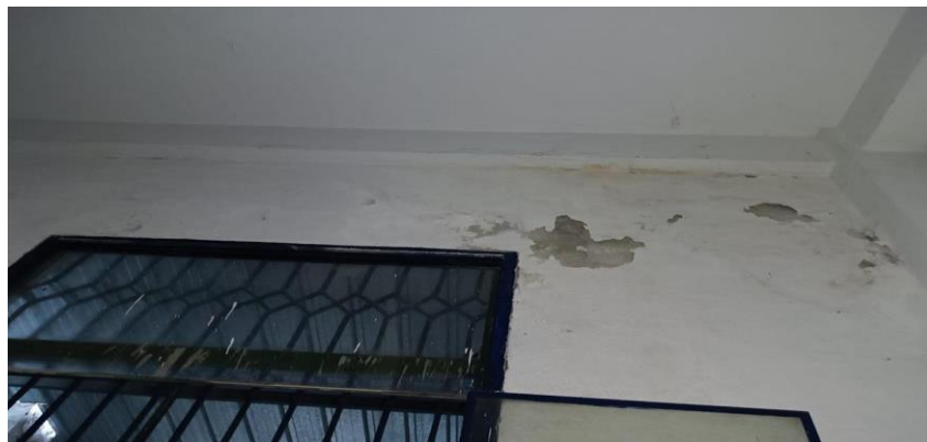
Ilustración 11 Lesión 4 Humedad por Filtración Fuente: Elaboración propia
