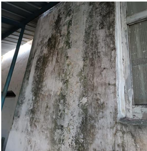
Ilustración 9 Lesión por humedad lesión 3
