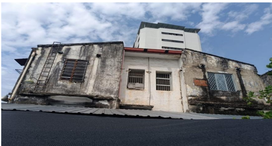
Ilustración 8 Lesión por humedad lesión 3 Fuente: Elaboración propia
