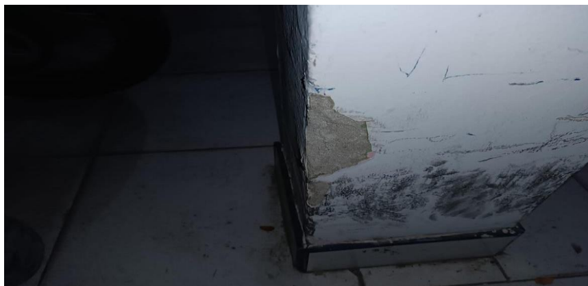
Ilustración 12 Lesión Mecánica Indirecta Ensuciamiento Fuente: Elaboración propia
