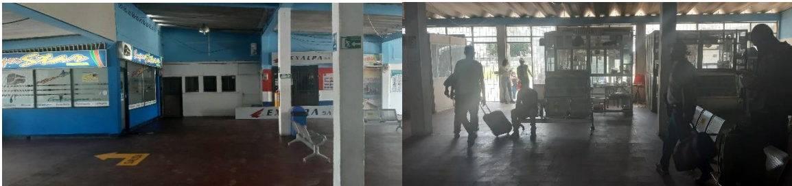
Figura 2. Deterioro de las instalaciones por falta de mantenimiento. (2022)
