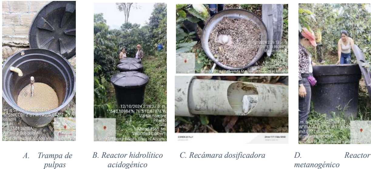
Figura 1. Sistema modular de tratamiento anaerobio (SMTA) 400
