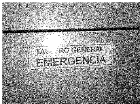
Fig.18 Tablero general de emergencia
