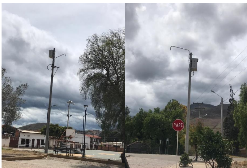
Fotografía 1. Instalación y unión de cámaras de seguridad en el parque principal
