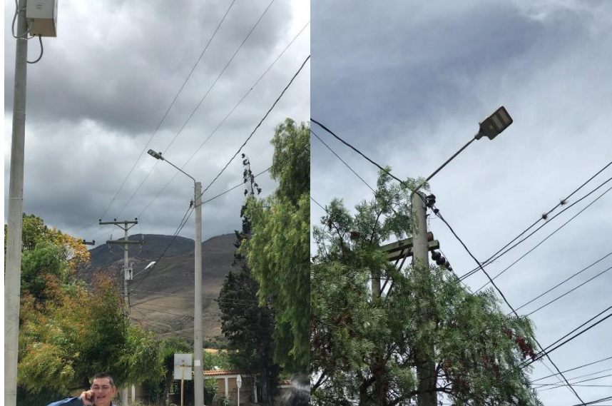
Fotografía 7. luminarias instaladas en la zona urbana
