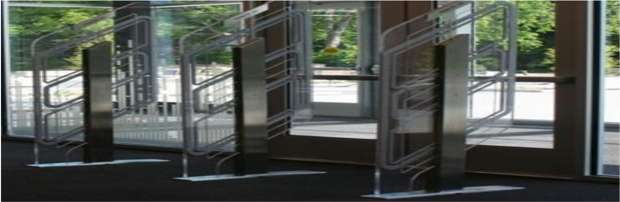
Figura 9. Imagen de las antenas de seguridad RFID, ya instaladas. Imagen suministrada por el proveedor.
