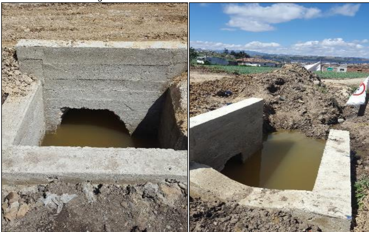
Fotografía 41: Alcantarilla fundida en el KM 0 + 000.
