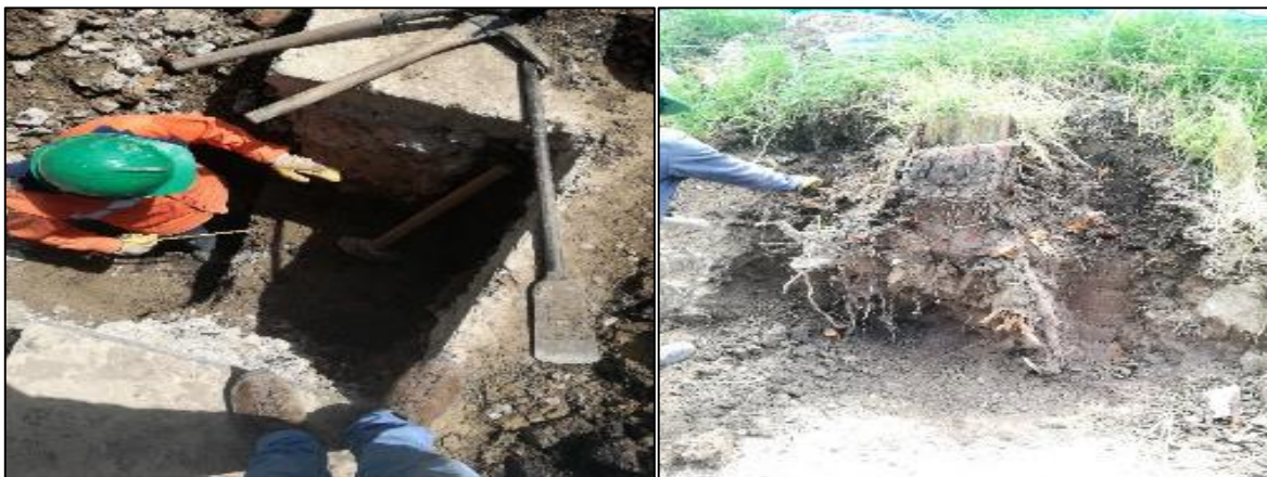
Fotografía 6: Sobre excavación en zapatas y presencia de raíces.
