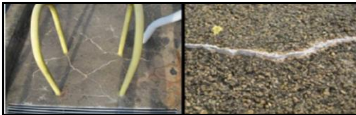
Fotografía No.8: Presencia de gel en las grietas – Fuente CESP (2013).
