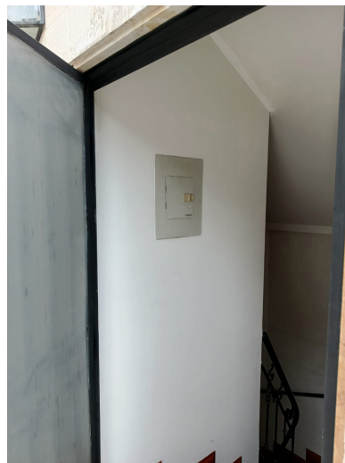
Figure 6. Caja de cableado
