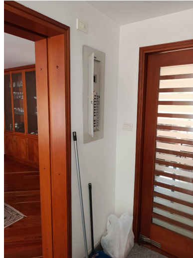
Figure 7. Tablero de conexiones
