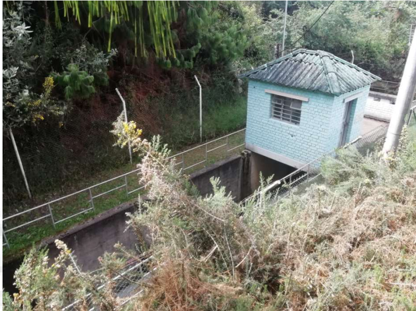
Fotografía. 6. Canal de descarga. Fuente: Consorcio Embalses CAR, 2020.
