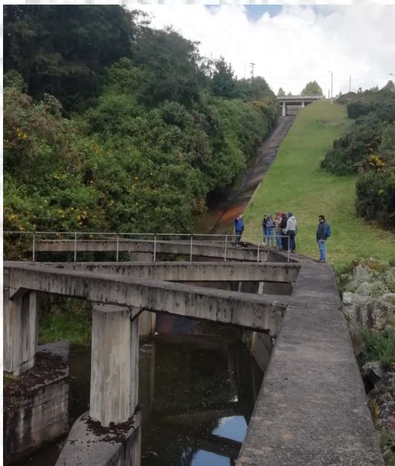
Fotografía. 8. Canal y vertedero de excesos.
