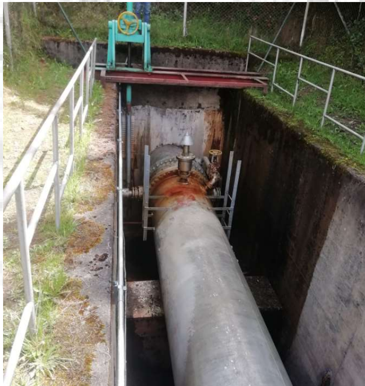
Fotografía. 7. Canal tubo descarga (interior). Fuente: Consorcio Embalses CAR, 2020.
