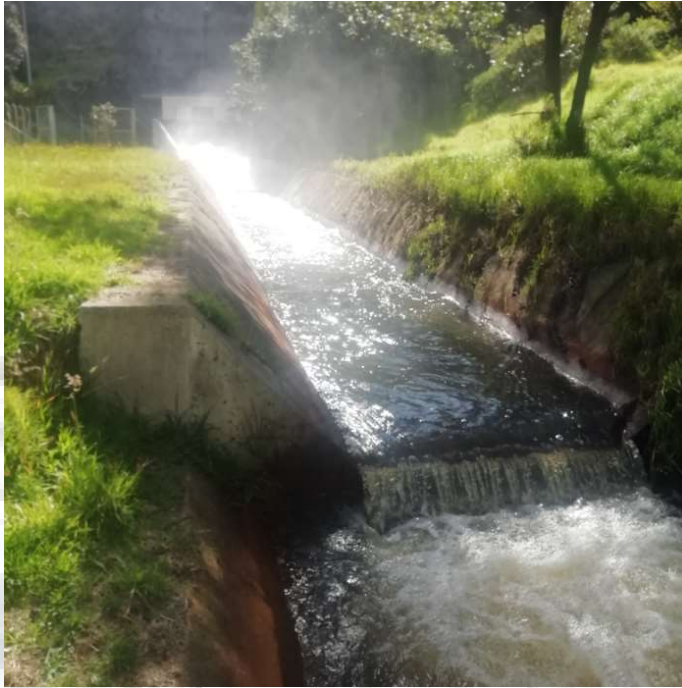
Fotografía. 12. Canal de descarga. Fuente: Consorcio Embalses CAR, 2020.
