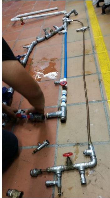
Figura 19 Desmontaje e identificación de elementos dañados.
