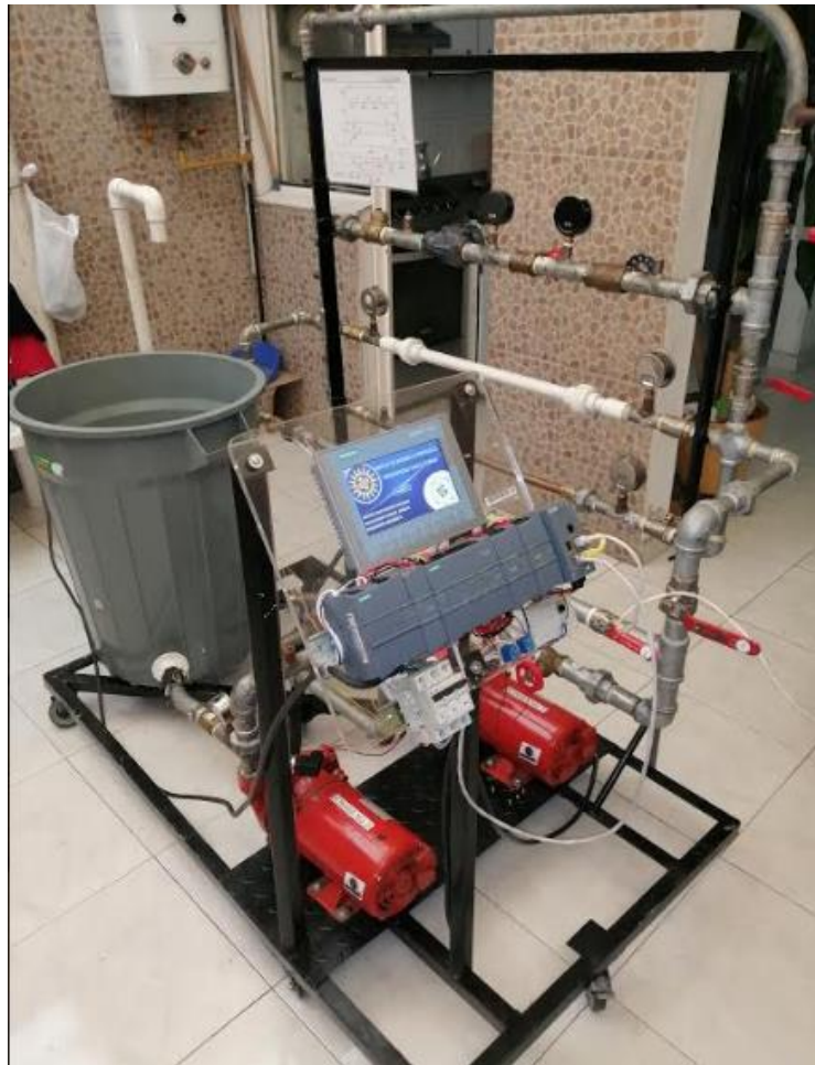
Figura 33 Banco de bombas actualmente.
