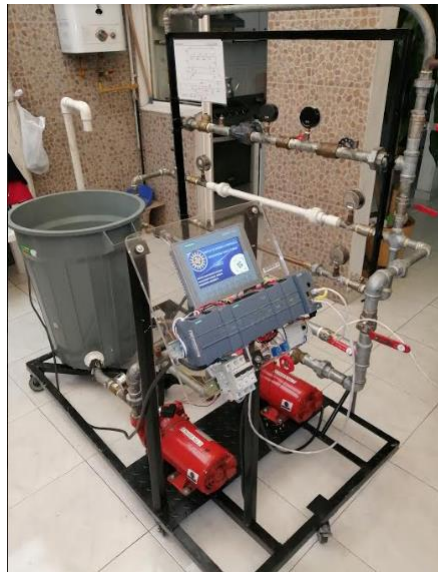
Figura 4 Banco de Bombas.
