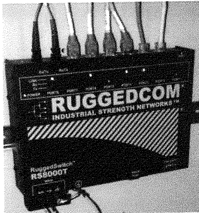
Fig. 29. Switch RUGGEDCOM presente en las Sub-estacione Fuente: Foto tomada por el autor en la Sub-estación Donato
