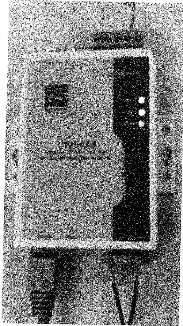
Fig. 36. Servidor NP301B conectado Fuente: Servidor del Autor
