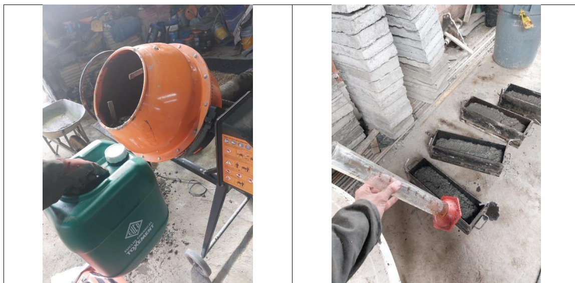
Figura 31. Dosificación de aditivos Toxement
