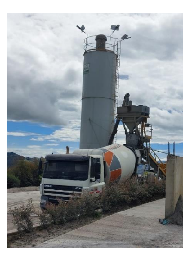
Figura 6. Planta de concreto
