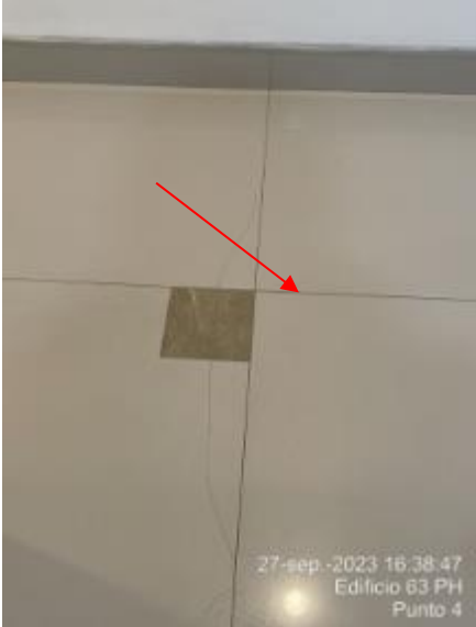
Baldosa fracturada pasillo piso 4
