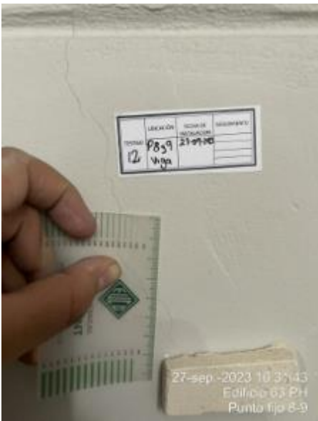
Fisura en viga punto fijo del piso 8 al 9
