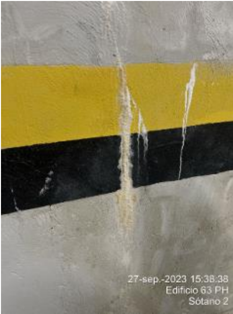
Presencia de Moho en Sótano 2
