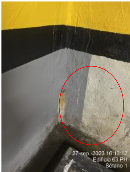
Filtración de agua muro sótano 1
