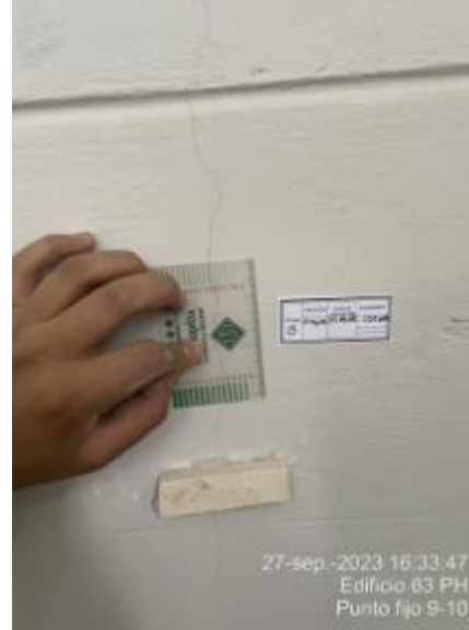
Fisura en viga punto fijo del piso 9 al 10
