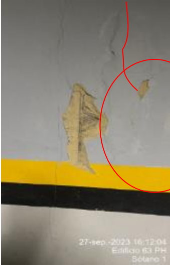
Fisuras y Desprendimiento del mortero de recubrimiento sótano 1
