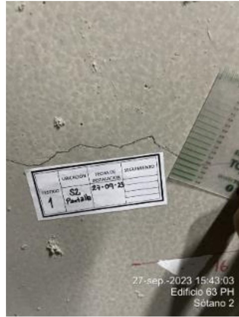
Fisuras en pantalla sótano 2
