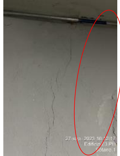
Fisura de placa a piso sótano 1
