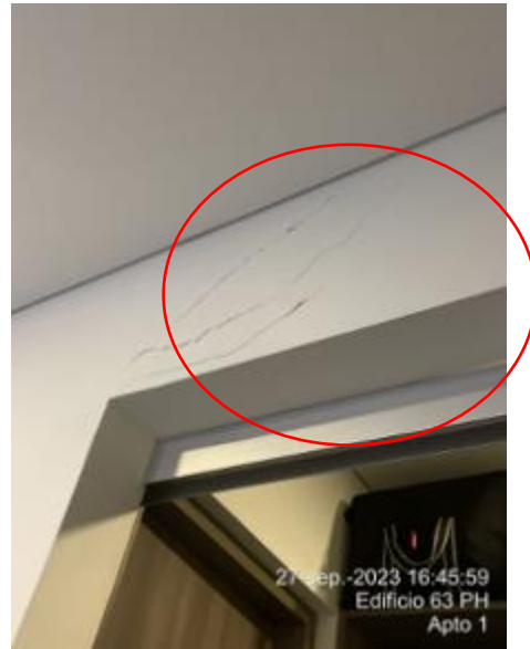
Apto 101 Borde Interno con fractura de elemento
