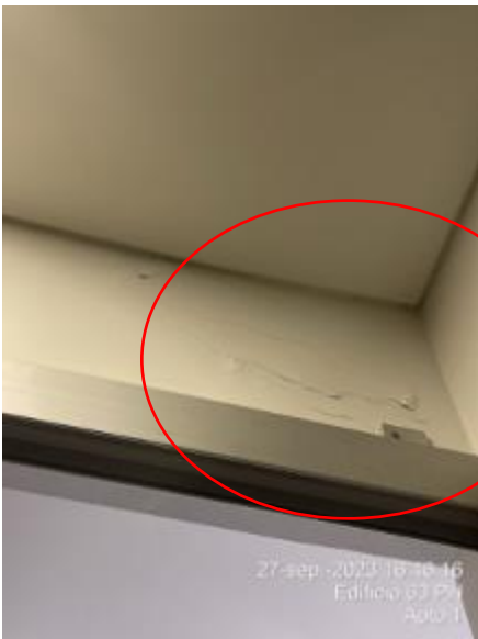
Apto 101 Borde Externo con fracturade elemento
