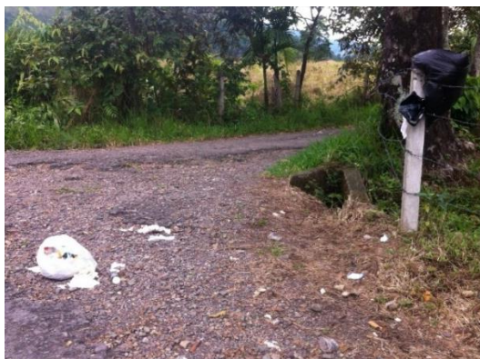
Figura 5. Intersección vial camino al mirador llanero con presencia de residuos dolidos sobre la carretera. Por Daniel Bohórquez, 2017.
