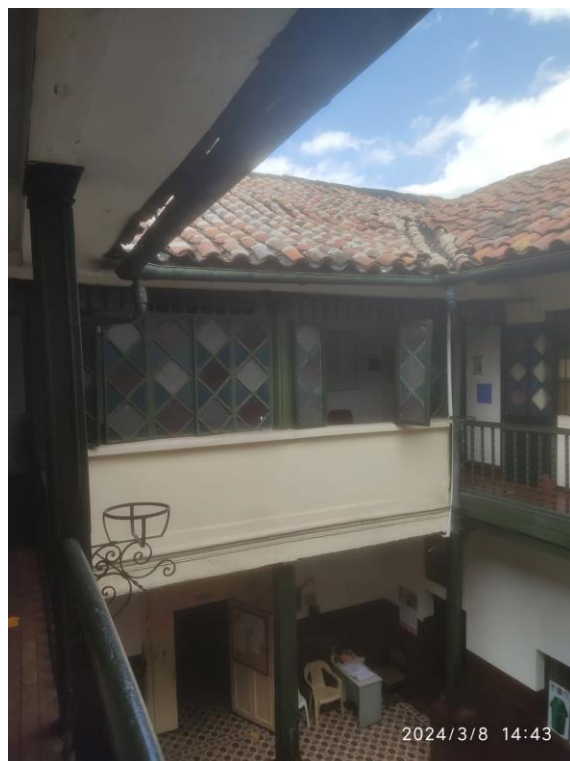
Figura 7-30, Cuarta lesión encontrada en la estructura – Fuente propia
