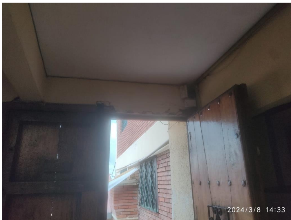
Figura 7-24, Segunda lesión encontrada en la estructura – Fuente propia
