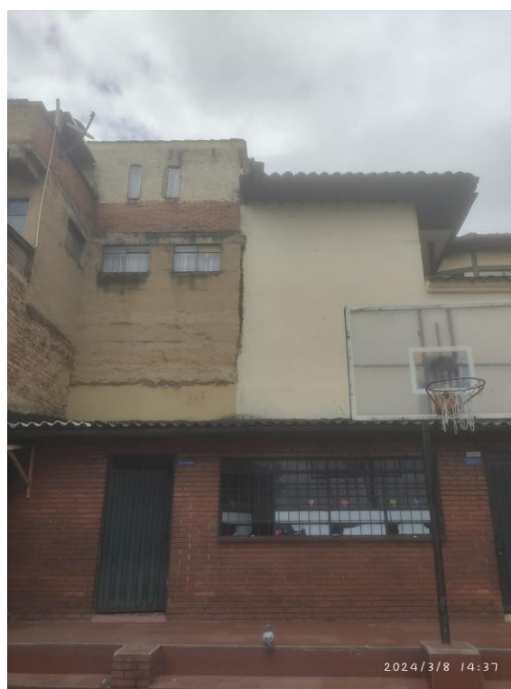
Figura 7-27, Tercera lesión encontrada en la estructura – Fuente propia
