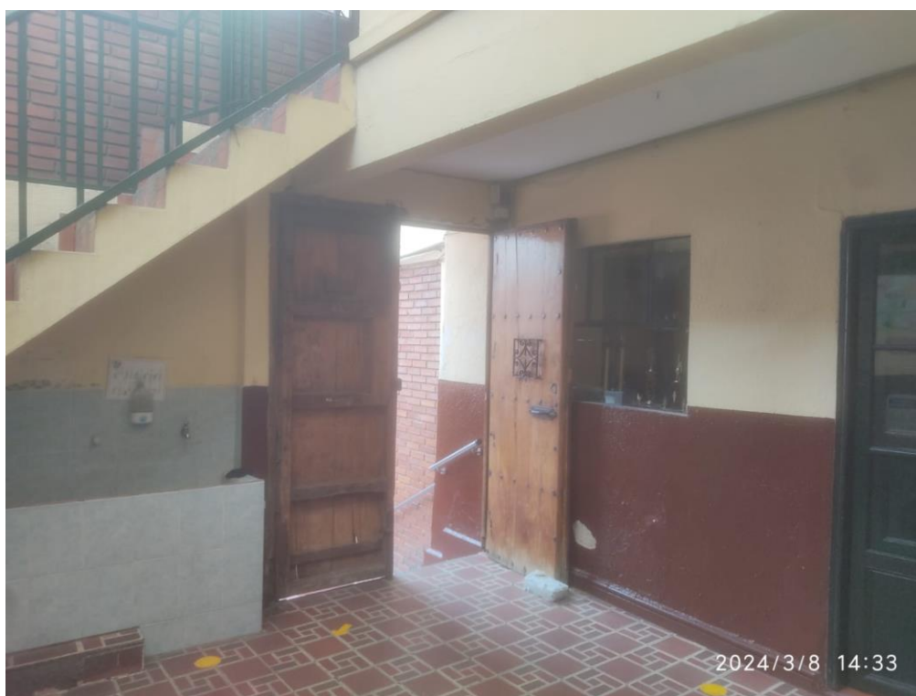
Figura 7-23, Segunda lesión encontrada en la estructura – Fuente propia
