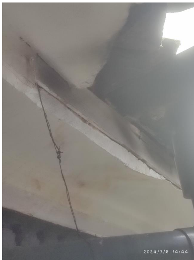
Figura 7-32, Cuarta lesión encontrada en la estructura – Fuente propia
