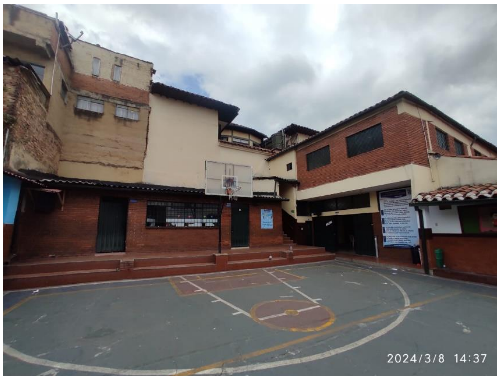
Figura 7-26, Tercera lesión encontrada en la estructura – Fuente propia
