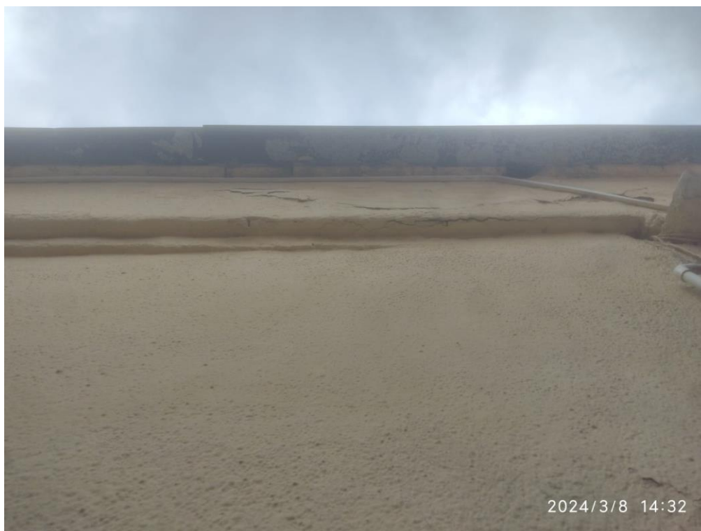
Figura 7-22, Primera lesión encontrada en la estructura – Fuente propia
