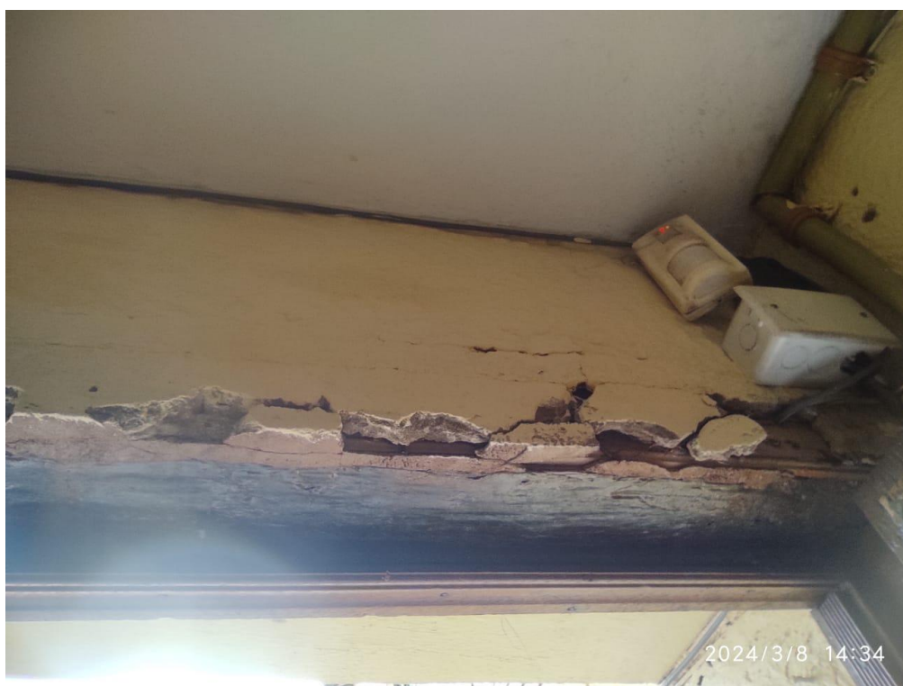
Figura 7-25, Segunda lesión encontrada en la estructura – Fuente propia
