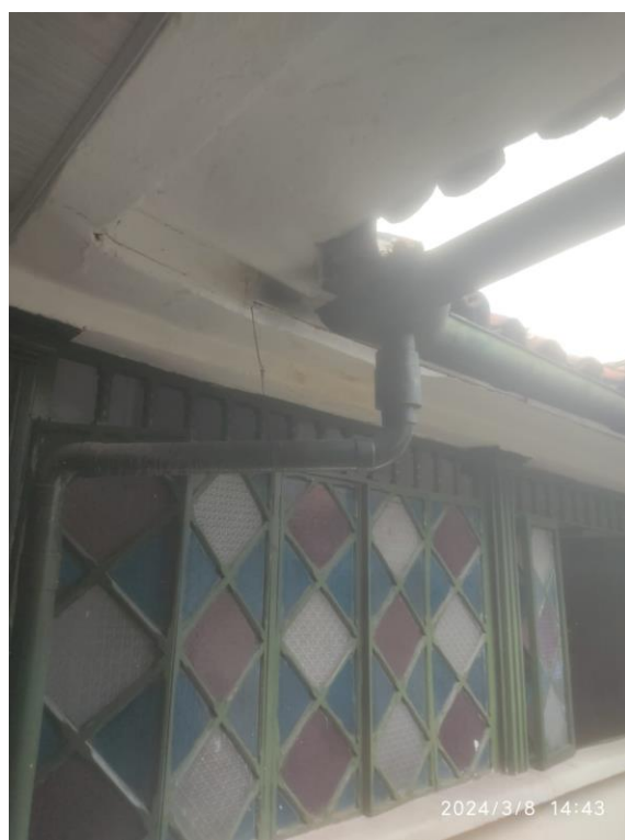
Figura 7-31, Cuarta lesión encontrada en la estructura – Fuente propia
