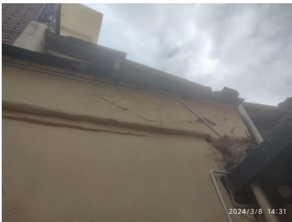
Figura 7-21, Primera lesión encontrada en la estructura – Fuente propia
