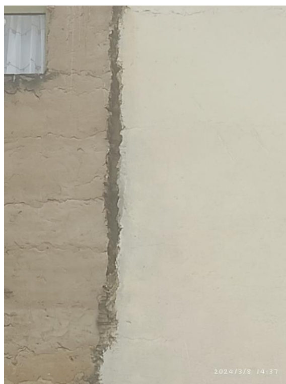
Figura 7-29, Tercera lesión encontrada en la estructura – Fuente propia
