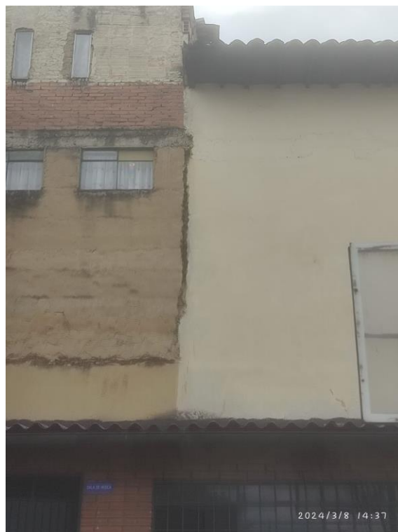
Figura 7-28, Tercera lesión encontrada en la estructura – Fuente propia
