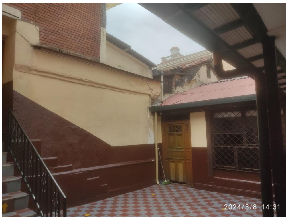
Figura 7-20, Primera lesión encontrada en la estructura – Fuente propia
