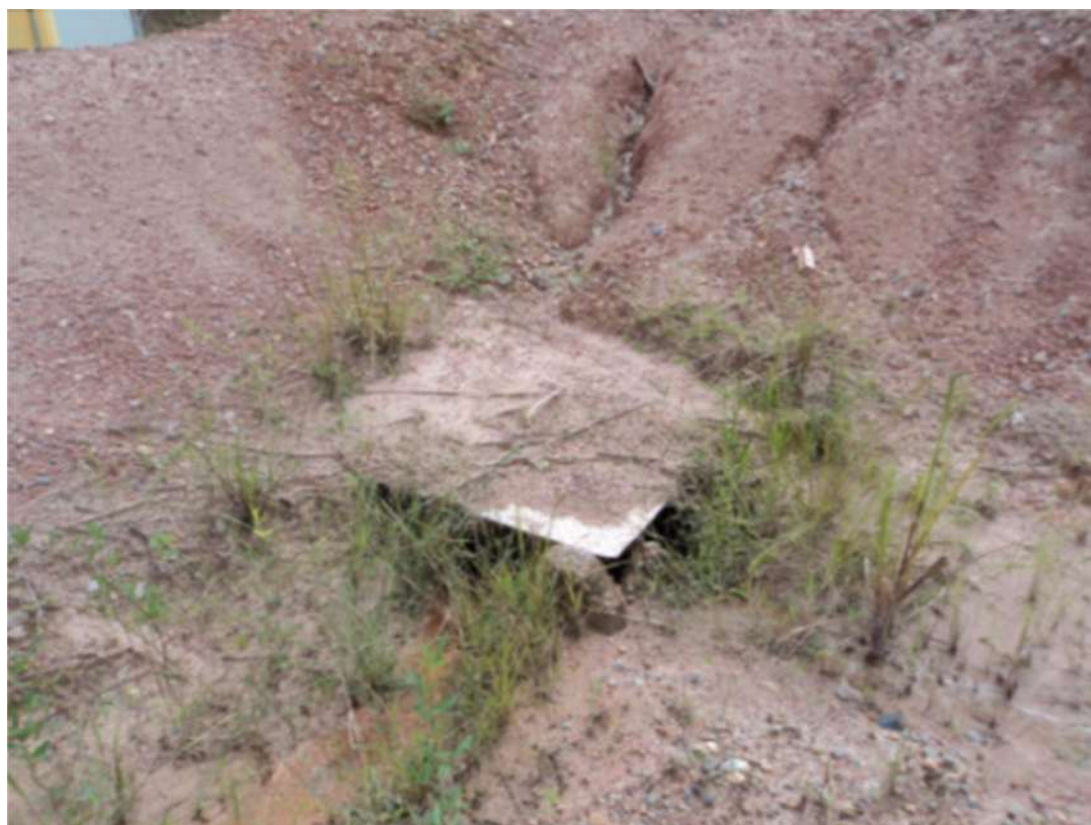
Figura 12. Vista del estado actual que se encuentra los muros de contención, Mayo 2019.
