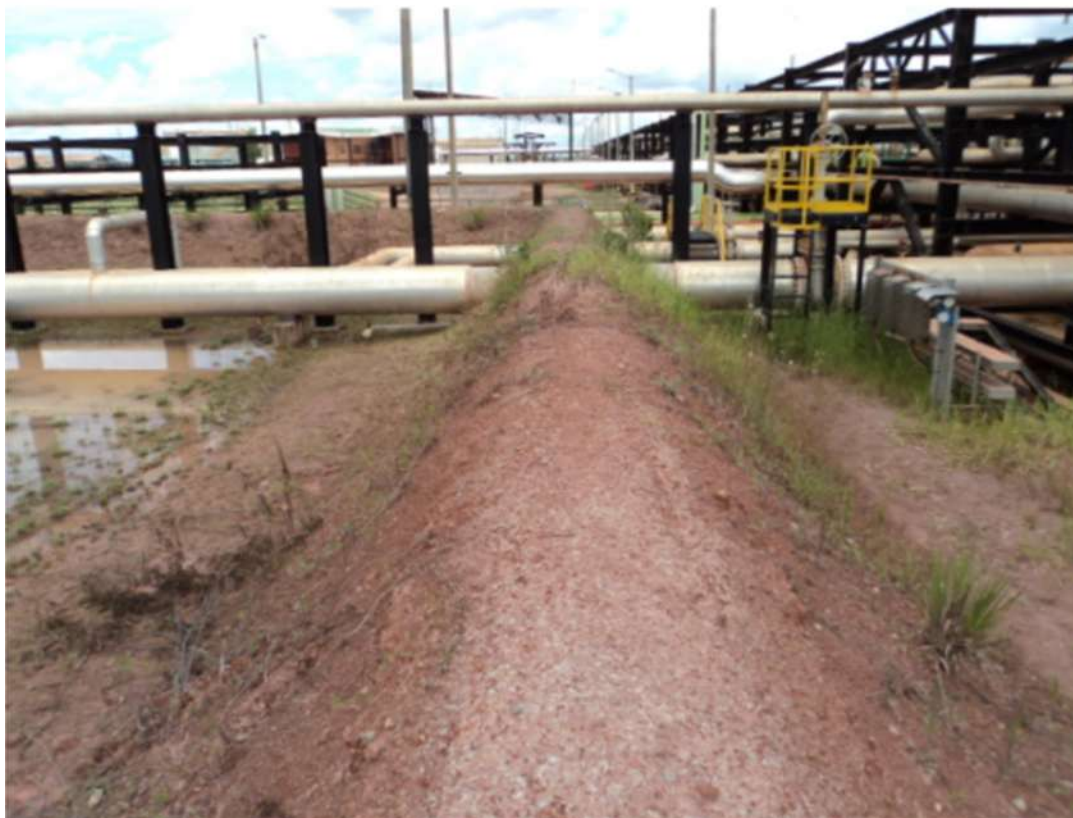
Figura 8. Vista del estado actual que se encuentra los muros de contención, Mayo 2019.
