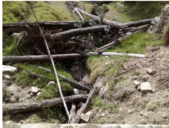
FIGURA 56. Obstrucción del canal por pérdida de material vegetal
