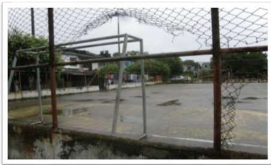
Fig. 2 Deterioro de malla
