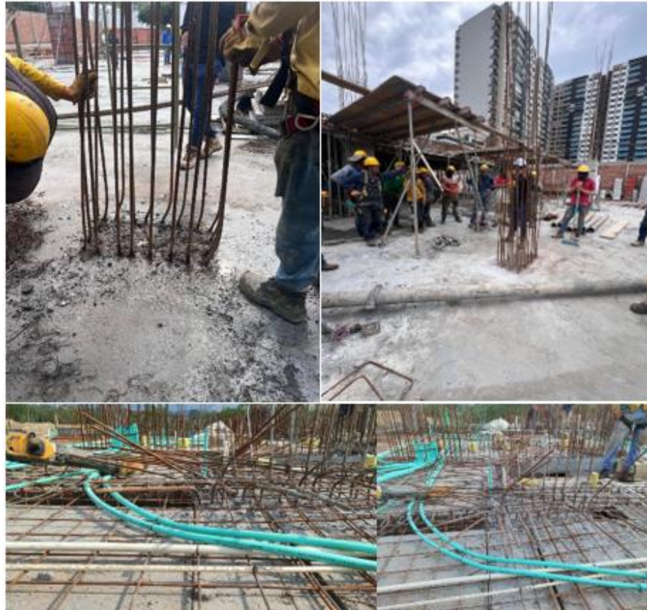
Figura 9. Malas prácticas en la manipulación del acero de refuerzo.
