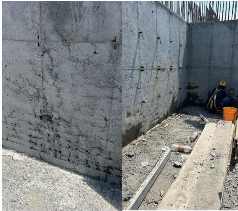
Figura 4. Errores y correcciones en el vibrado de muros.
