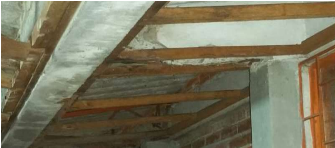
Figura 17 Humedad de Infiltración-Viga Canal Interna – Fuente: Propia
