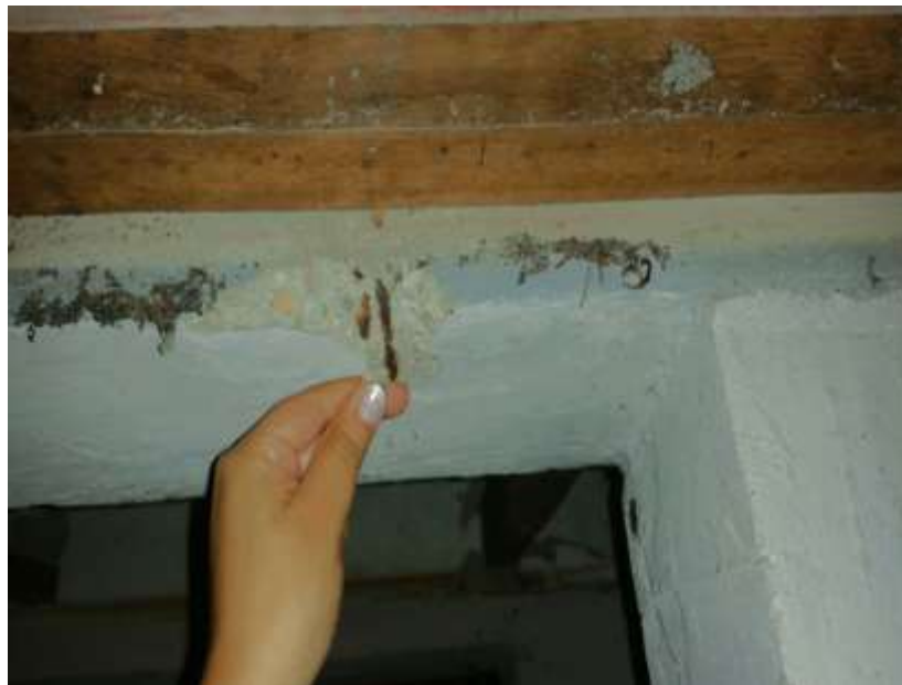
Figura 12 Desprendimiento Fuente: Propia
