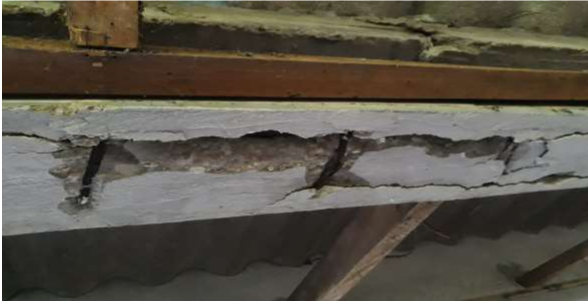
Figura 12 Exposición del acero de refuerzo- Fuente: Autores
