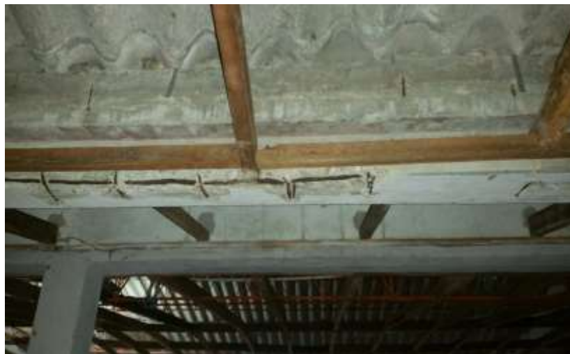
Figura 21 Corrosión por oxidación Fuente Propia
