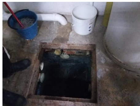
Fotografía 3-4 Caja de inspección y ducto de agua de salida de la PTAR
