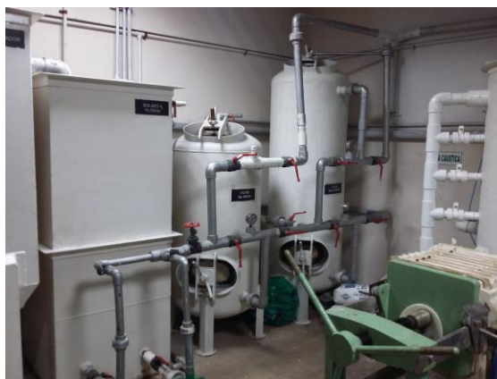
Fotografía 1-3 Filtro de arena y carbón activado
