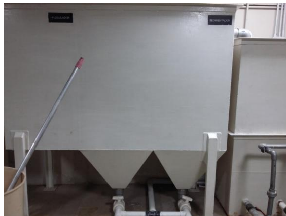
Fotografía 1-2 Tanque floculador y sedimentador
