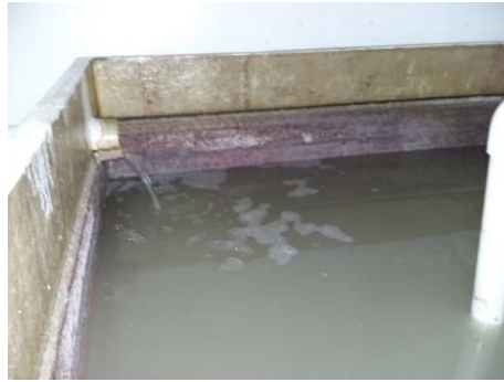
Fotografía 3-2 Tanque de almacenamiento de agua residual
