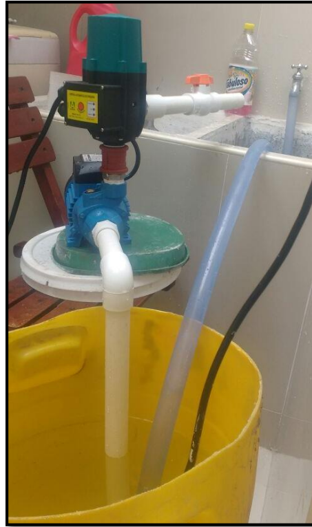
Figura 3-19. Presurizador y electrobomba. Fuente: Autores.
