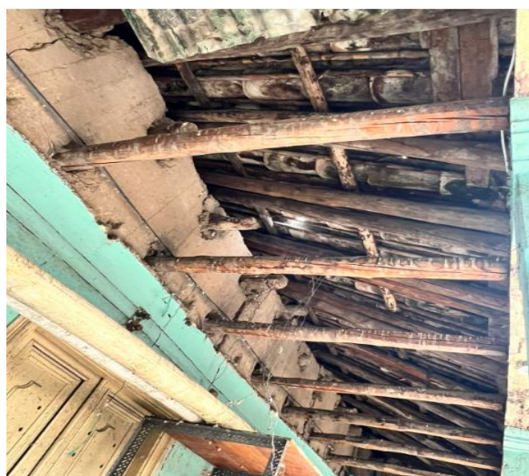
Ilustración 4 Patología en cubierta
