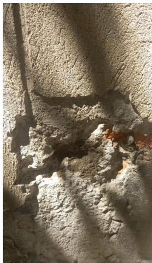
Figura 10. Aplicación prueba con fenolftaleína Columneta 3H
