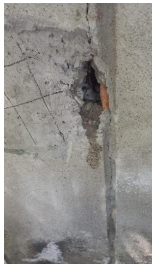
Figura 11. Aplicación prueba con fenolftaleína Columneta 4H
