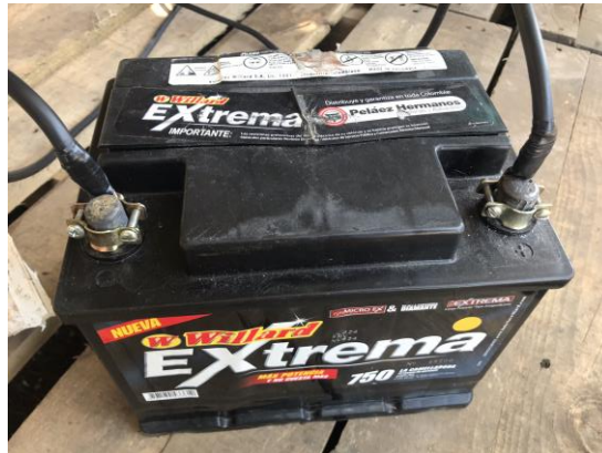
Imagen 46 Conexión a la batería con seguros Fuente: Autores
