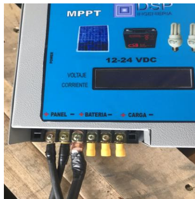
Imagen 45 Conexión en Paralelo panel- controlador Fuente: Autores
