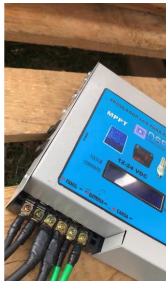
Imagen 47 Conexión de los equipos al controlador Fuente: Autores
