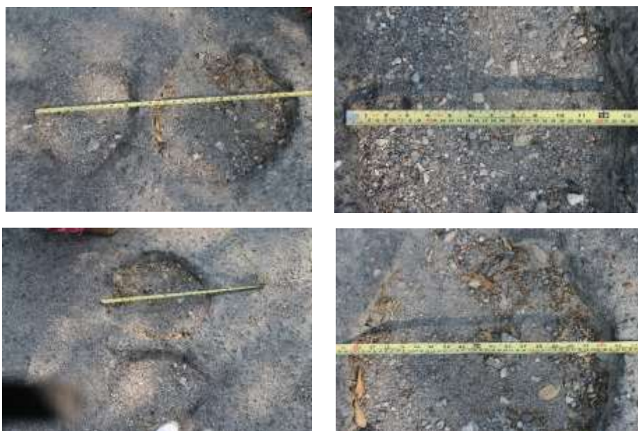
Figura 9. Falla 7 Descascaramiento (Km3+400)
