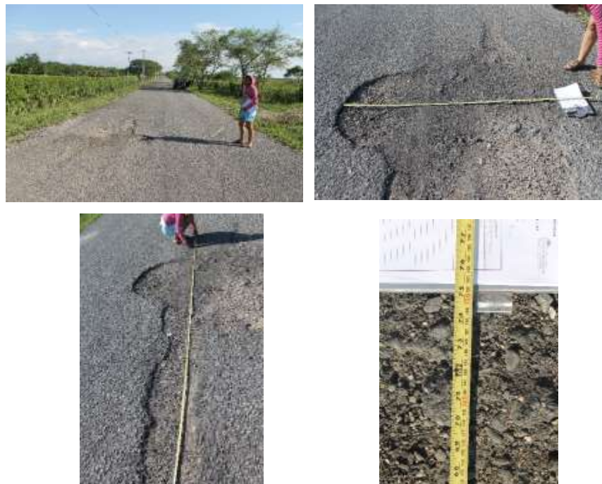
Figura 11. Falla 9 Descascaramiento y Desgaste superficial (Km1+510)
