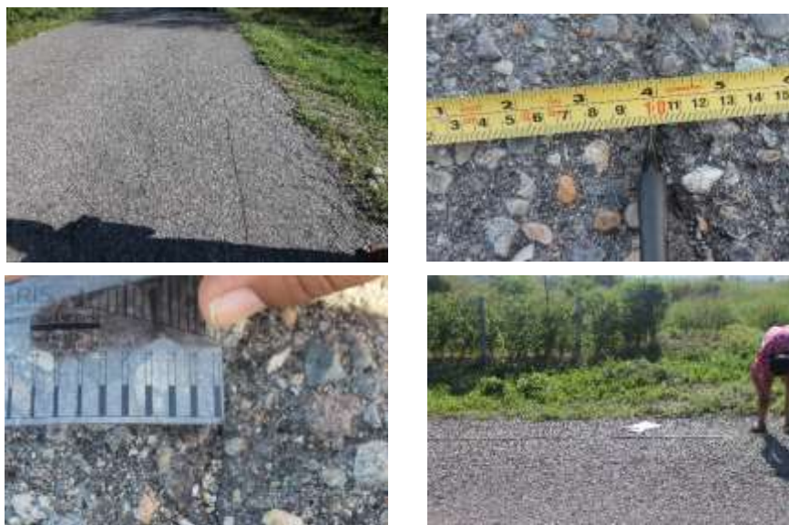
Figura 12. Falla 10 Fisura de borde y desgaste de superficial (Km1+210)
