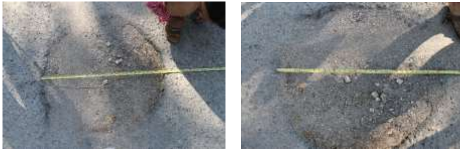
Figura 8. Falla 6 Descascaramiento (Km3+840)
