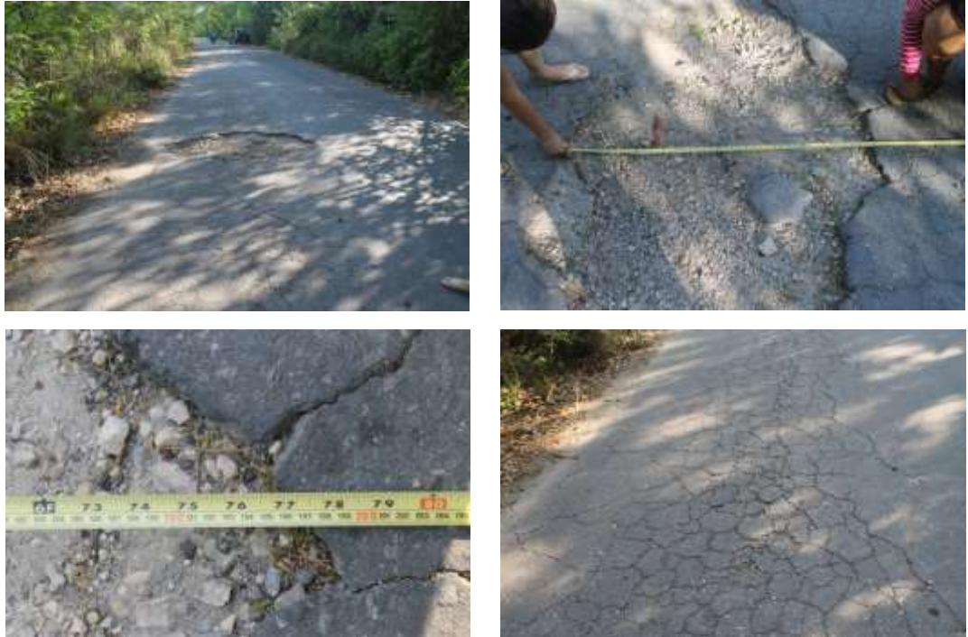
Figura 14. Falla 12 Piel de cocodrilo (Km1+750)
