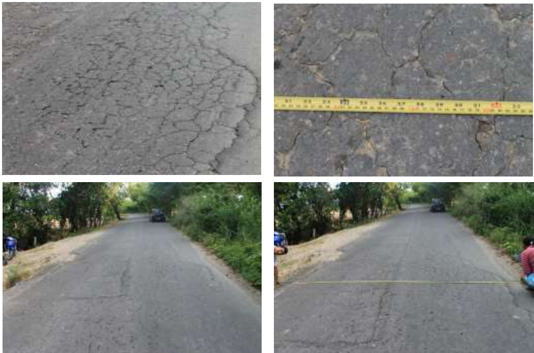
Figura 15. Falla 13 Piel de cocodrilo y parche (Km2+540)
