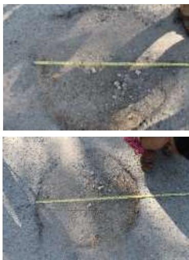
Falla 6: Descascaramiento (Km3+840)
