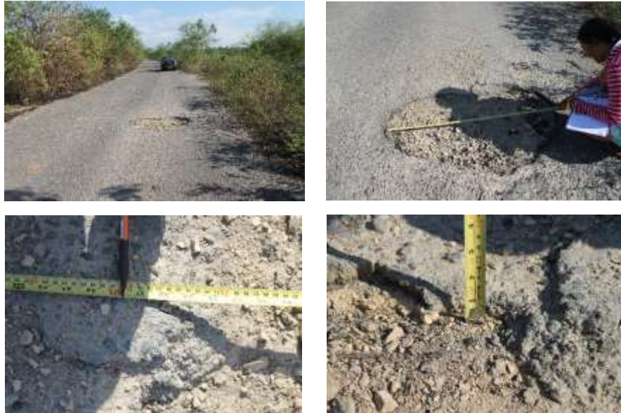
Figura 10. Falla 8 Bache (Km2+860)
