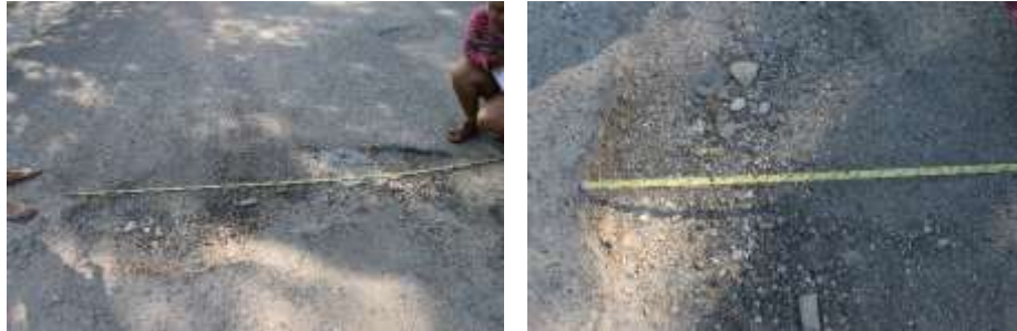
Figura 7. Falla 5 Descascaramiento (Km4+140)
