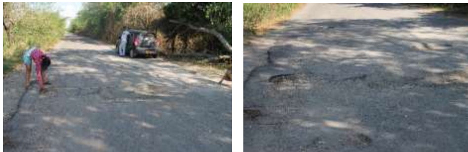
Figura 6. Falla 4 Descascaramiento (Km4+540)
