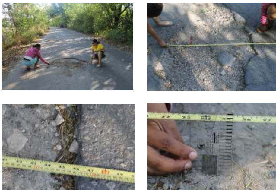
Figura 13. Falla 11 Descascaramiento (Km1+100)
