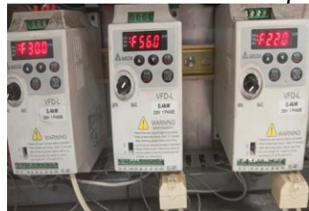
Figura 2. Variadores de frecuencia de motores en línea de etiquetado
