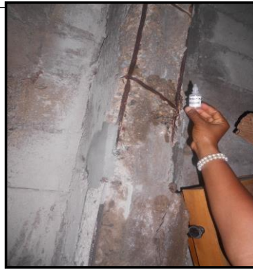
FENOLTALEINA EN ELEMENTO DETERIORADO (Columna)
