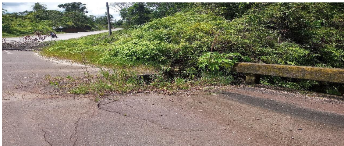
Imagen 3. Vegetación y grietas
