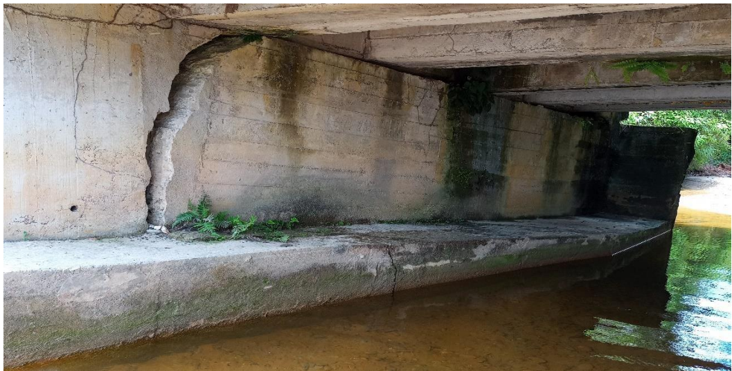
Figura 11. Asentamiento puntual en estribo del pontón. (fuente autor)
