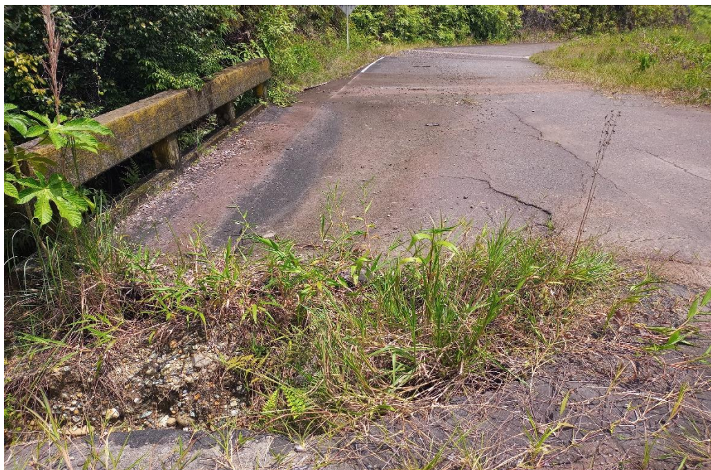
Figura 12. Grietas en la losa del pontón. (fuente autor)
