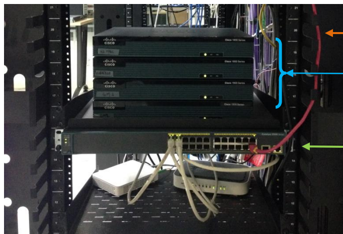
Patch Cord entre (SW Laboratorio Ortezal y SWITCH_GETVPN)
