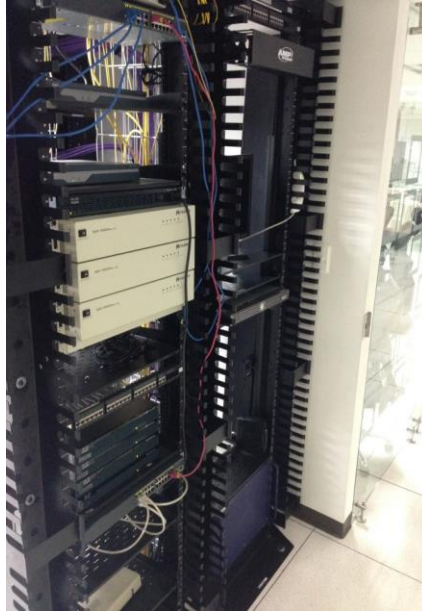
Figura 1. Rack Laboratorio Ortezal
