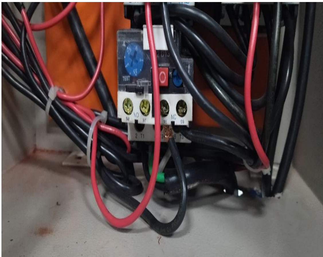
Figura 36. Cableado sin terminales y con mala conexión, esta conexión pudo haber provocado un corto en el sistema.
